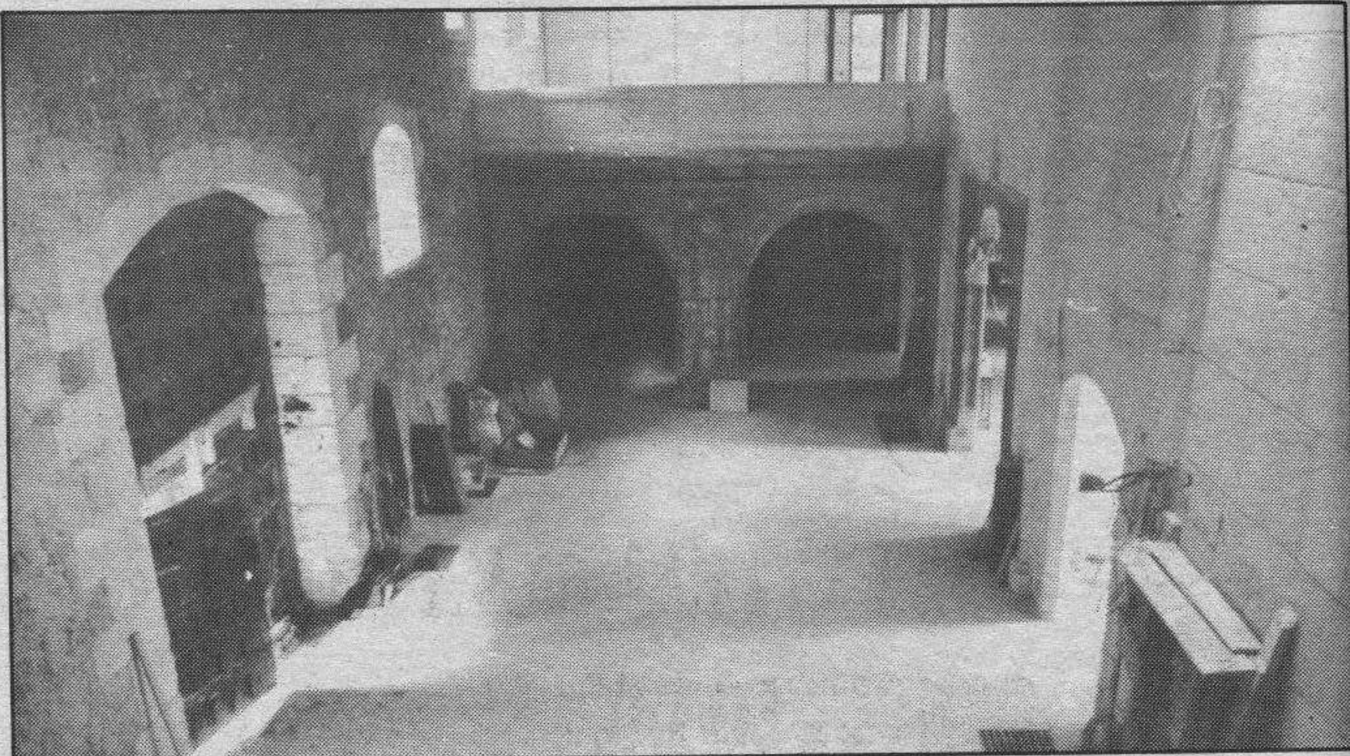
Interior de la Casa de Angulo donde están a punto de concluir las obras de adaptación del histórico inmueble para el museo burgalés
