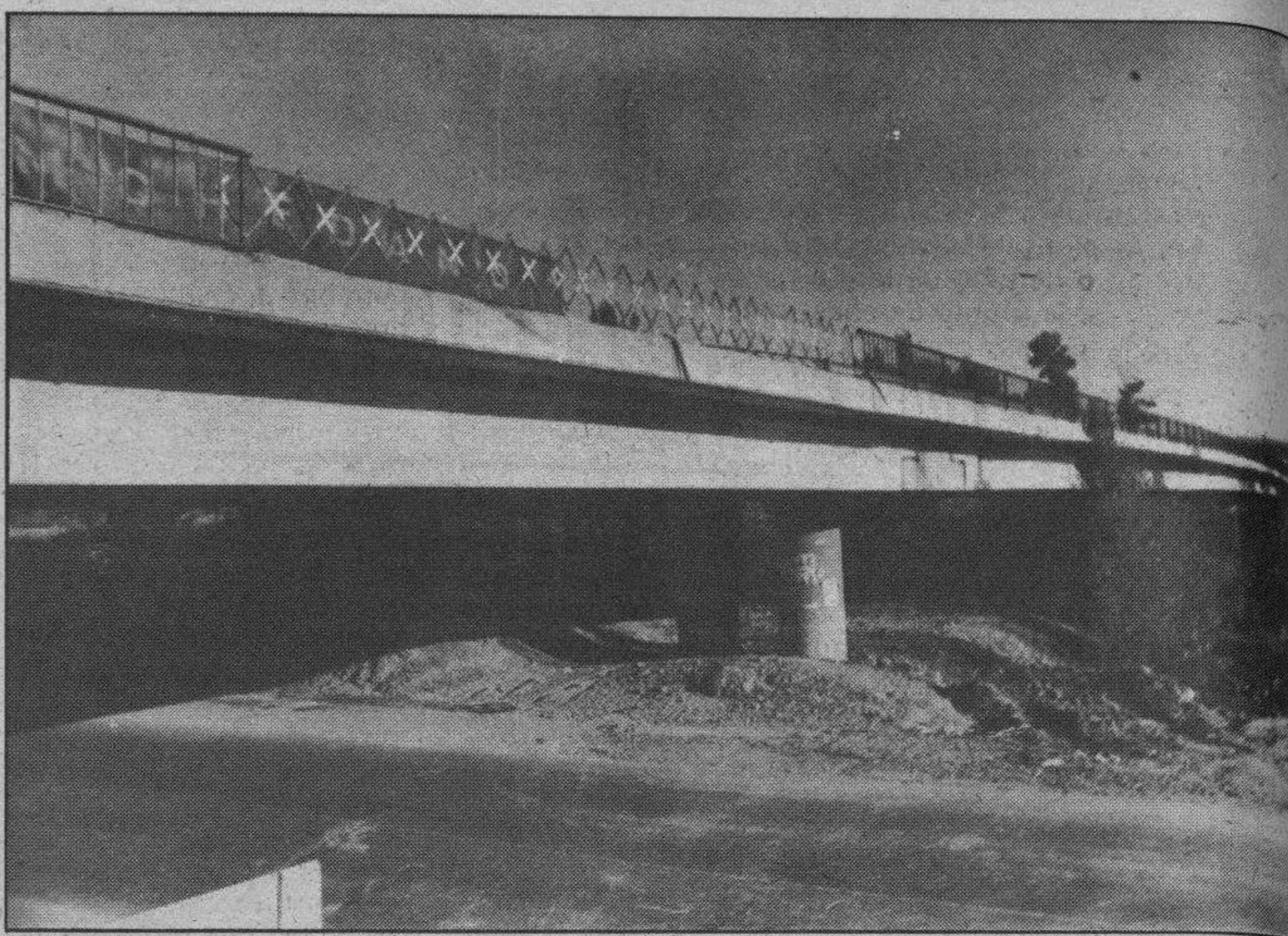
Así ha quedado el puente sobre el Duero después del aparatoso accidente del martes. — Foto Lara.
