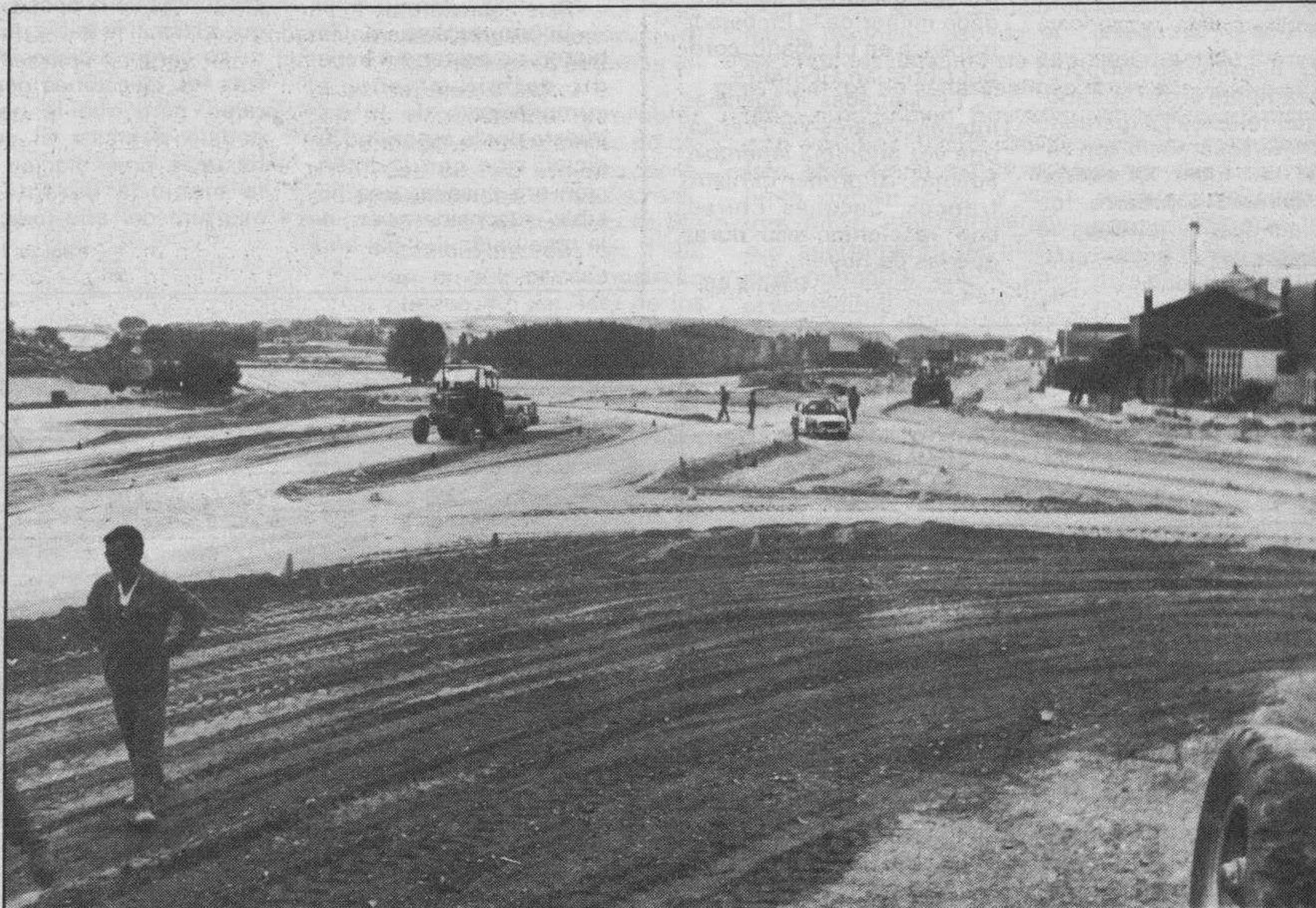
Importantes obras. — En el término de La Horra y en el entronque con la carretera a Palencia se están llevando a cabo trabajos de mejora de esta ruta, que se reciben con satisfacción por los ribereños. Parece es un lugar donde se han producido bastantes accidentes de tráfico y el proyecto tiende a aumentar la seguridad de los peatones y, por supuesto, de los conductores. Ello es positivo. — Foto Lara.
