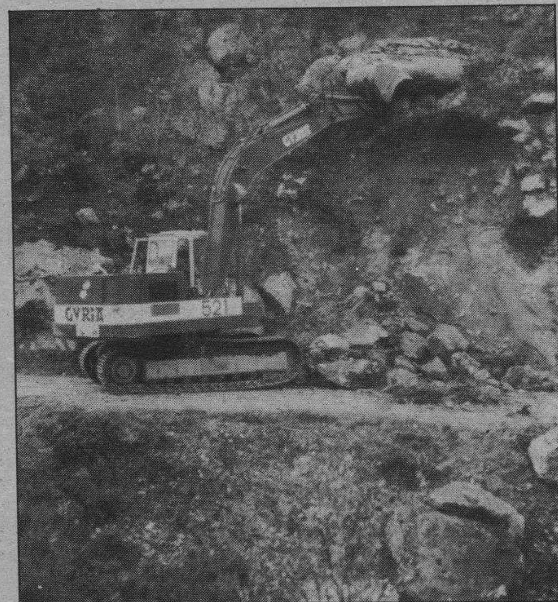
En la carretera de Basconcillos, en Hoyos del Tozo, la máquina de la Diputación retirando peñascos
