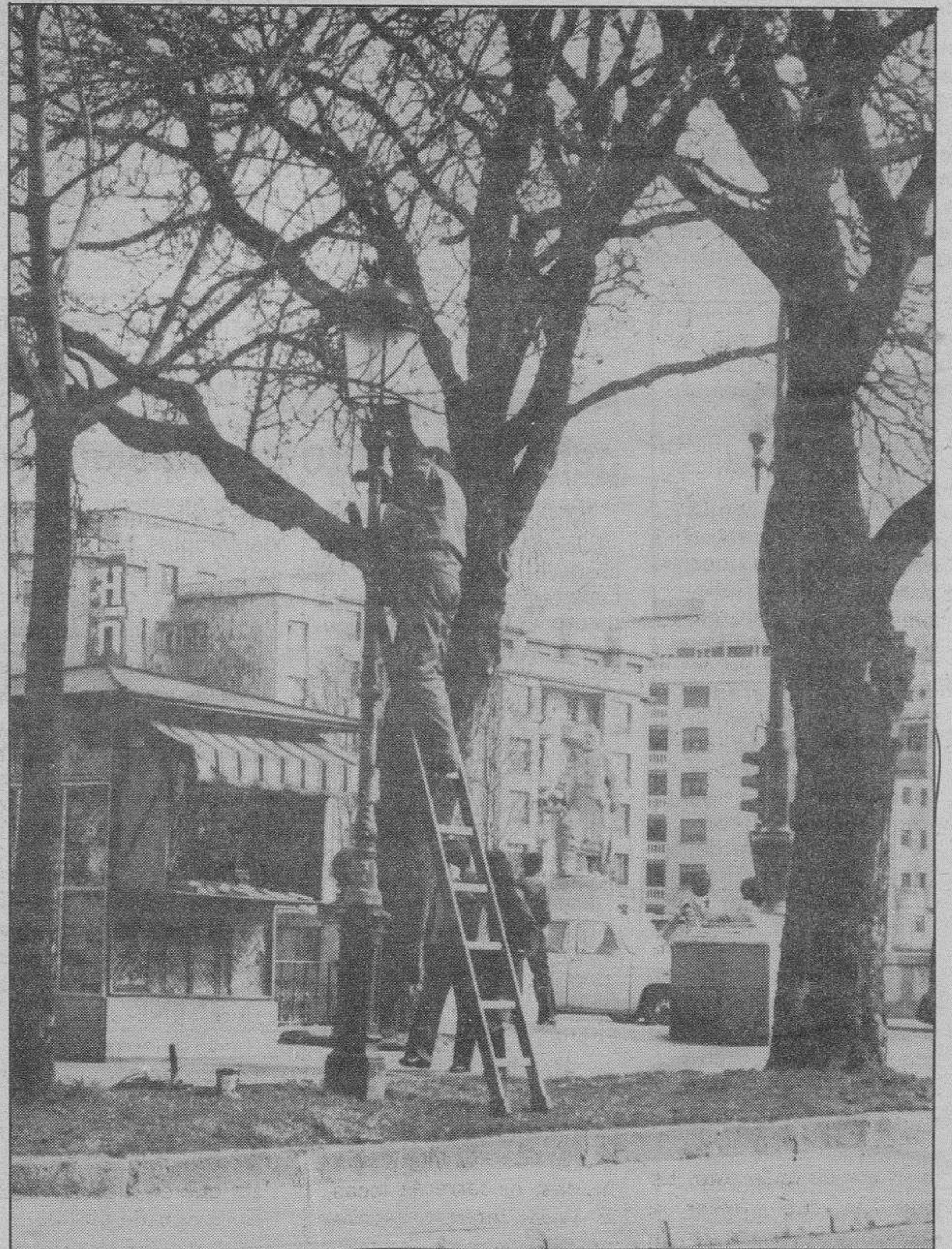
REPARANDO EL ALUMBRADO. — Una escena urbana habitual. Los servicios de conservación y mantenimiento han procedido en los últimos días a la reparación de las artísticas farolas de algunos paseos y parques de la ciudad, una atención permanente que tiene su interés.
