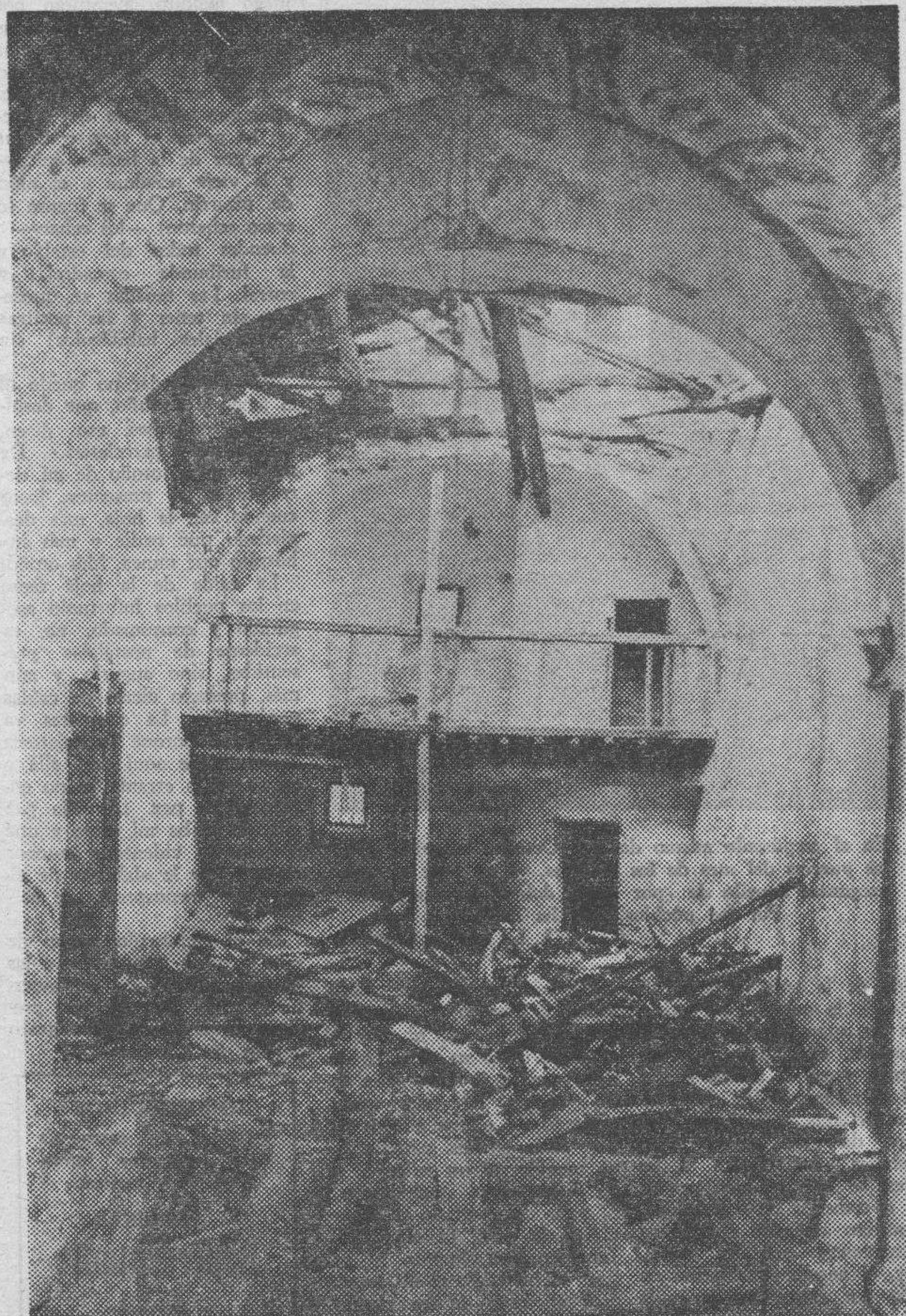
Interior deplorable de la iglesia de Puentes de Amaya, saqueada totalmente. ¡Vandalismo por todo lo alto!
