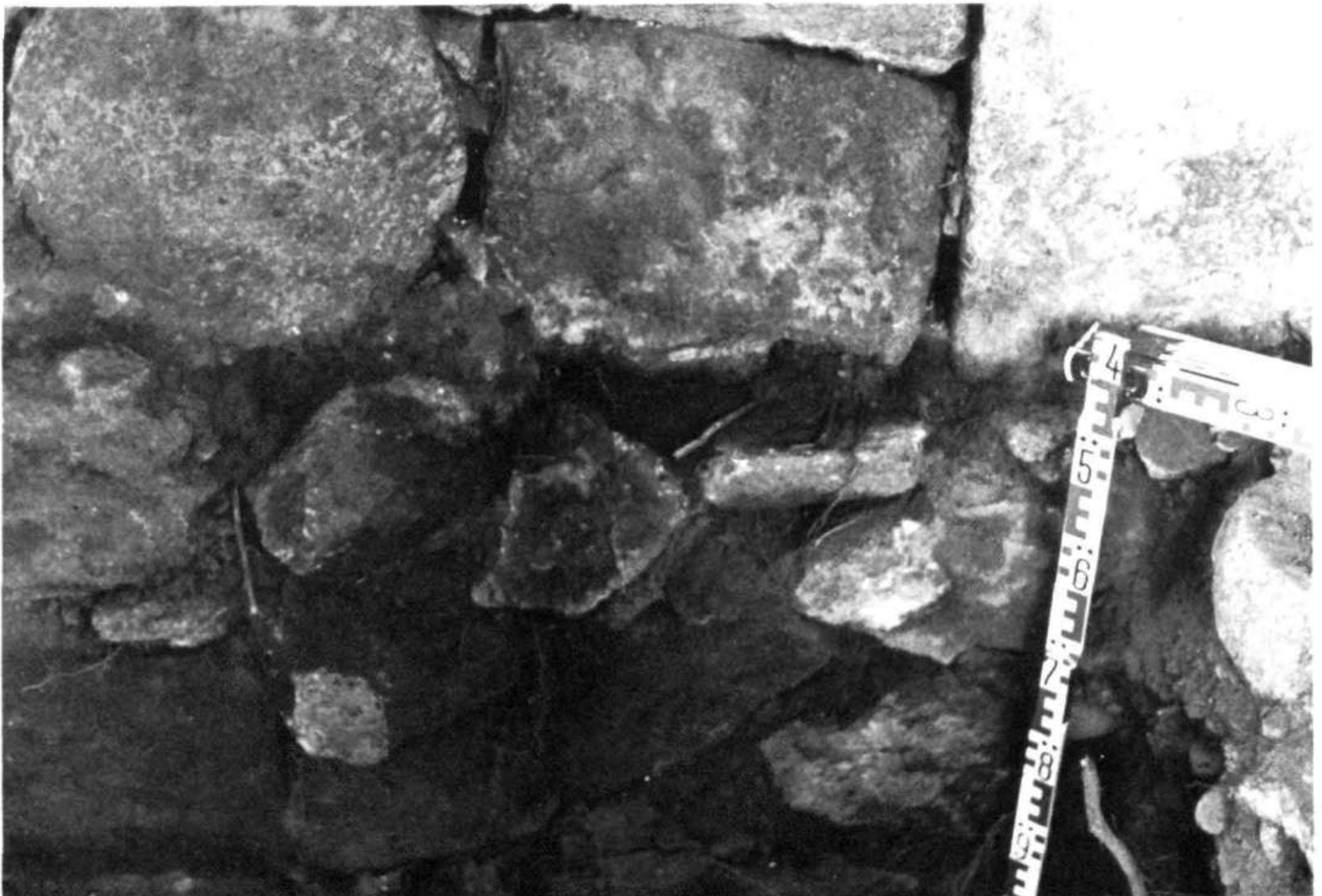
2.—Cata 17. Detalle de los cimientos e hilada inferior del muro septentrional de la construcción actual.
