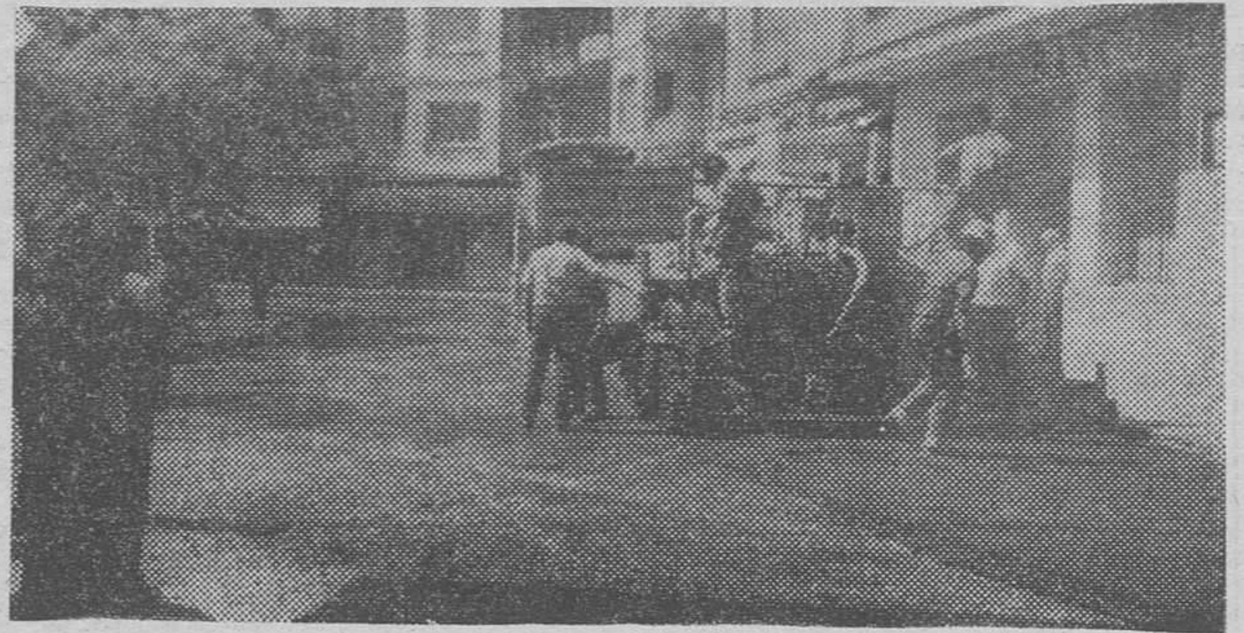
Obras de pavimentación de la Plaza del 7 de Agosto, en Aranda de Duero. (Foto REYES)
