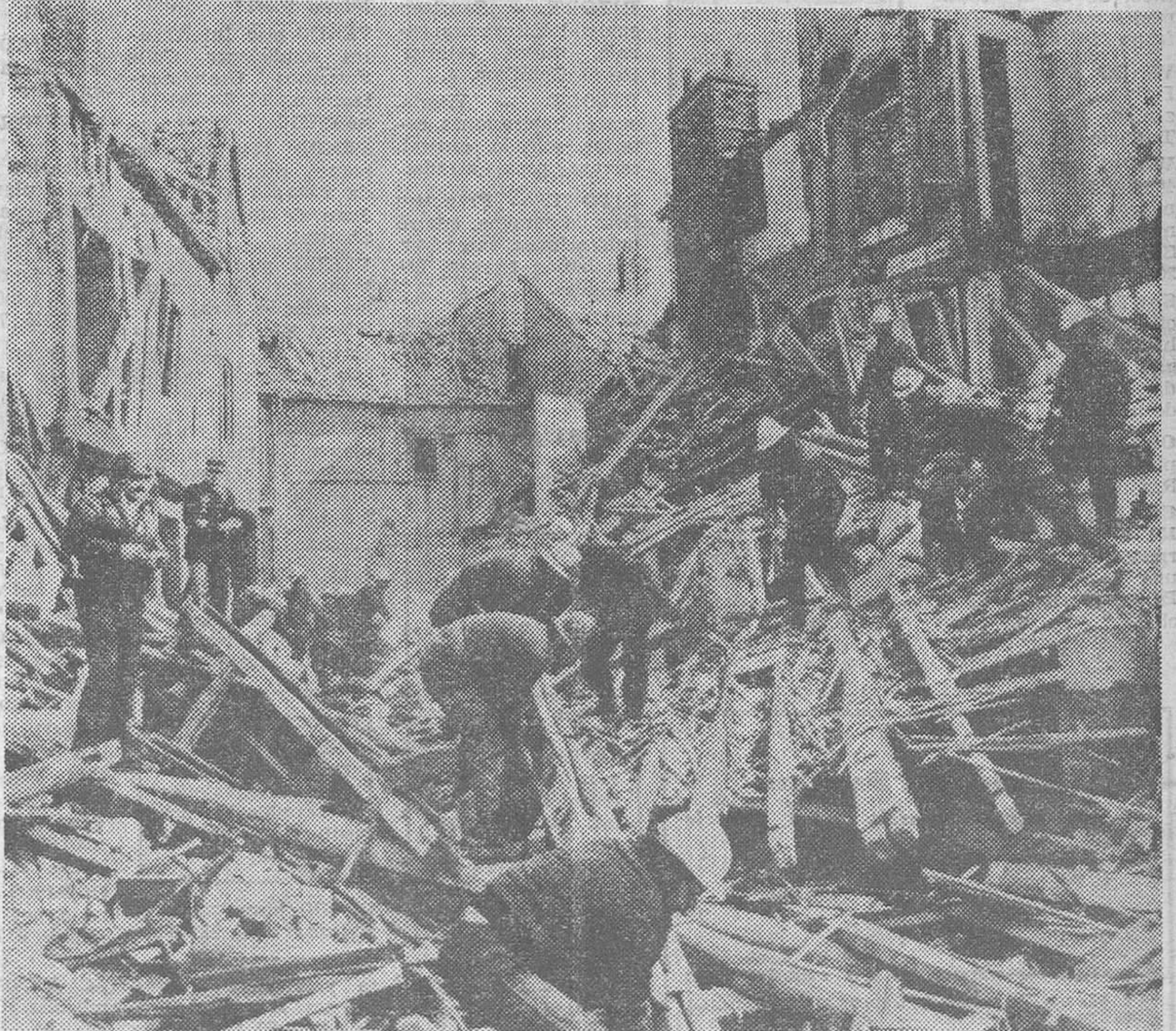
Joigny (Francia). — Miembros del equipo de bomberos y varios soldados se afanan en las tareas de desescombro, tras la explosión de gas ocurrida el pasado martes en el centro de la ciudad de Joigny, que afectó a cinco casas destruyéndolas casi por completo y causó graves heridas a cinco personas. Joigny está situada al Suroeste de París. — (Telefoto EFE-AP).
