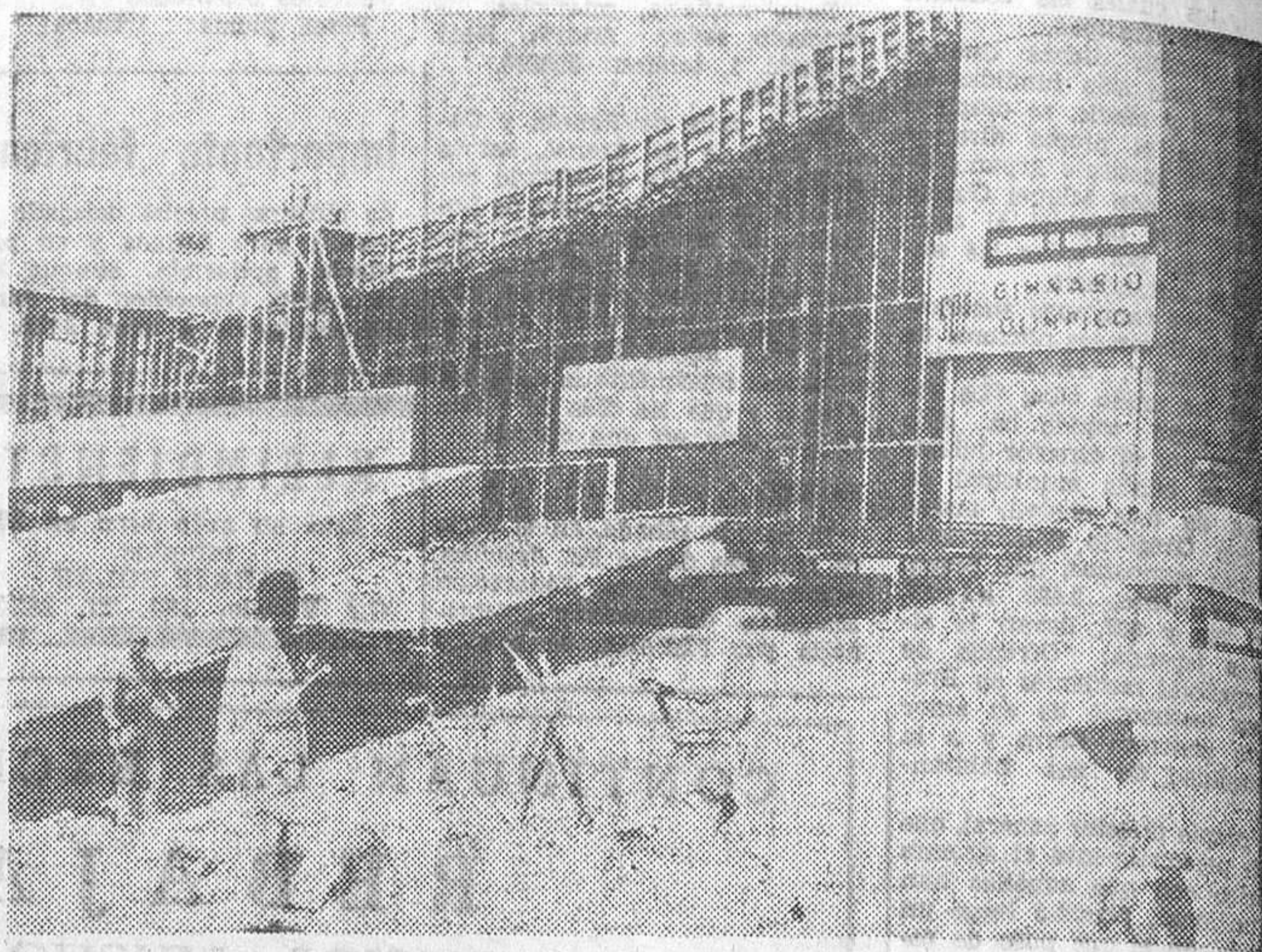
Méjico. — Un aspecto de las obras que se llevan a cabo para la construcción del Gimnasio Olímpico. — (Telefoto UPI-CIFRA)
