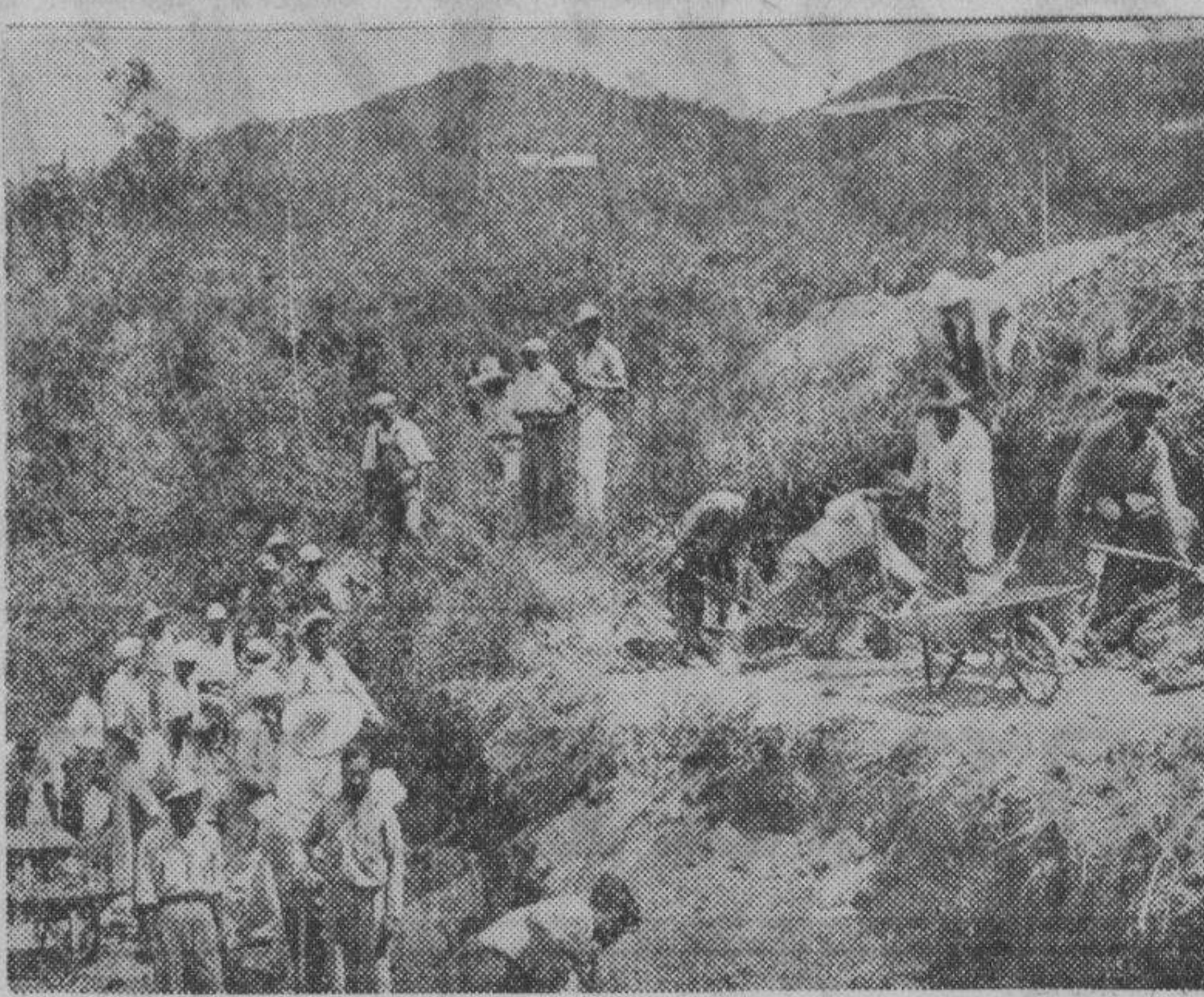
Obreros excavando la tierra para los cimientos del nuevo molino de la Salacot Mining Co., en Bulacan. Los trabajos comenzaron el 26 de febrero último.
