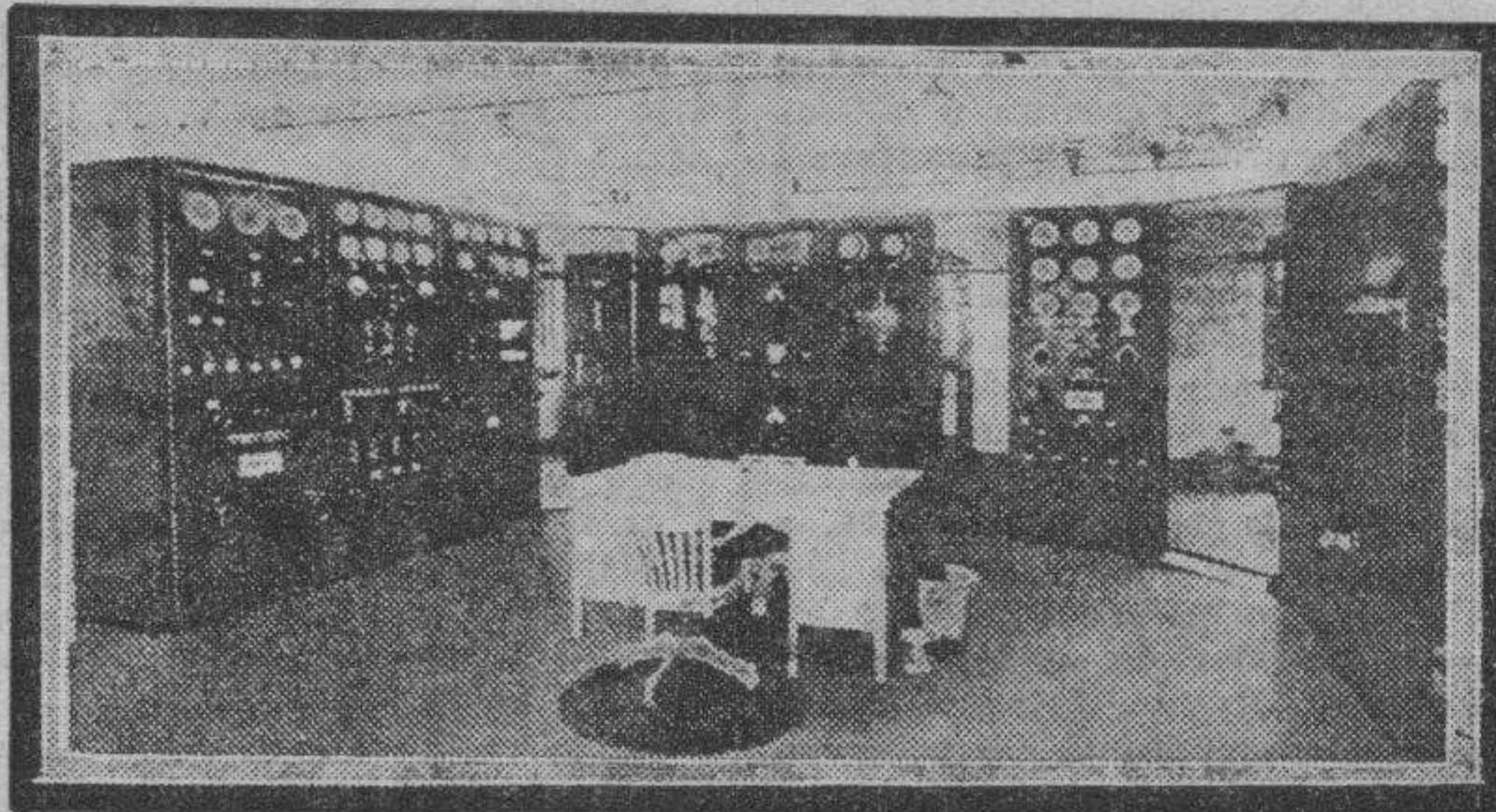
Ofrecemos hoy a nuestros lectores una vista parcial de la emisora de Roma, una de las más potentes y mejor modulada de Europa (75 kilowatios en antena), construida por la Radio Corporation of America.
