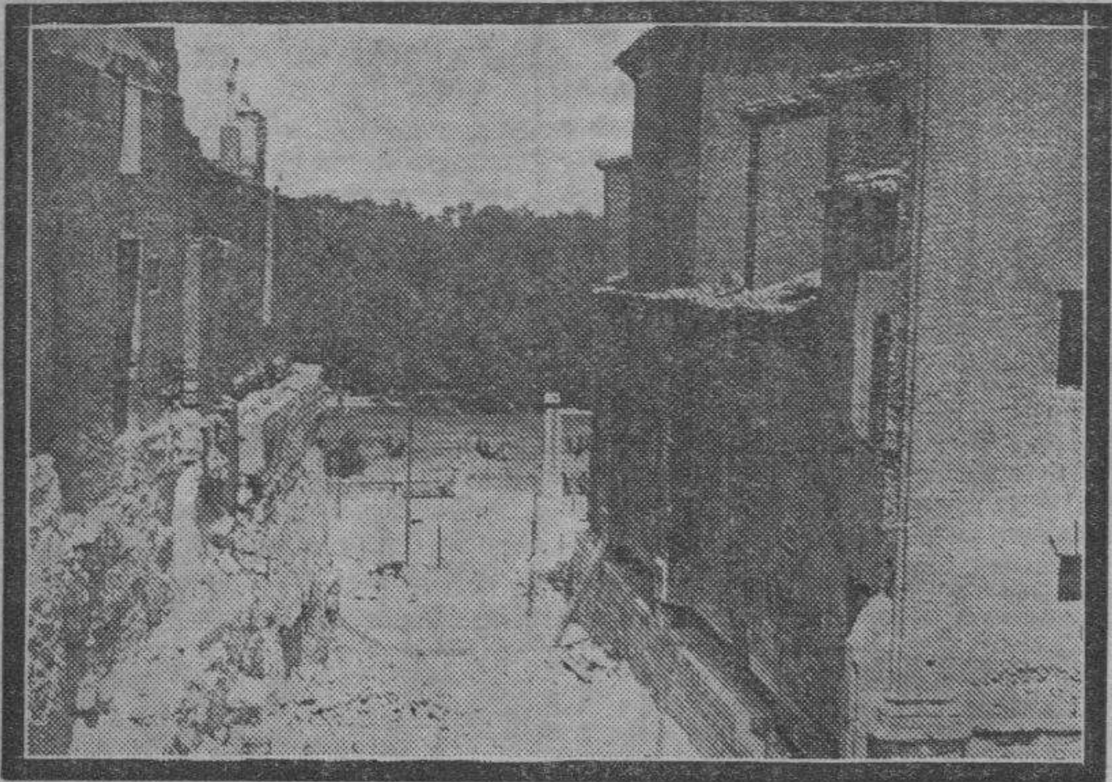
Nuevo aspecto zaragozano. La "calle" entre el torreón de La Zuda y la iglesia de San Juan de los Panetes que sale al paseo del Ebro. Obsérvense las obras realizadas para sostener el edificio, que queda ahora aislado y libre de las humedades que tanto le perjudicaban.
