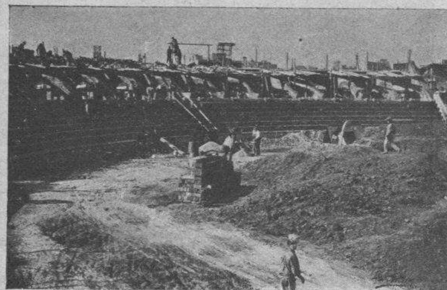
Enero de 1900.—Interior del tendido de sombra, visto desde la puerta principal.
