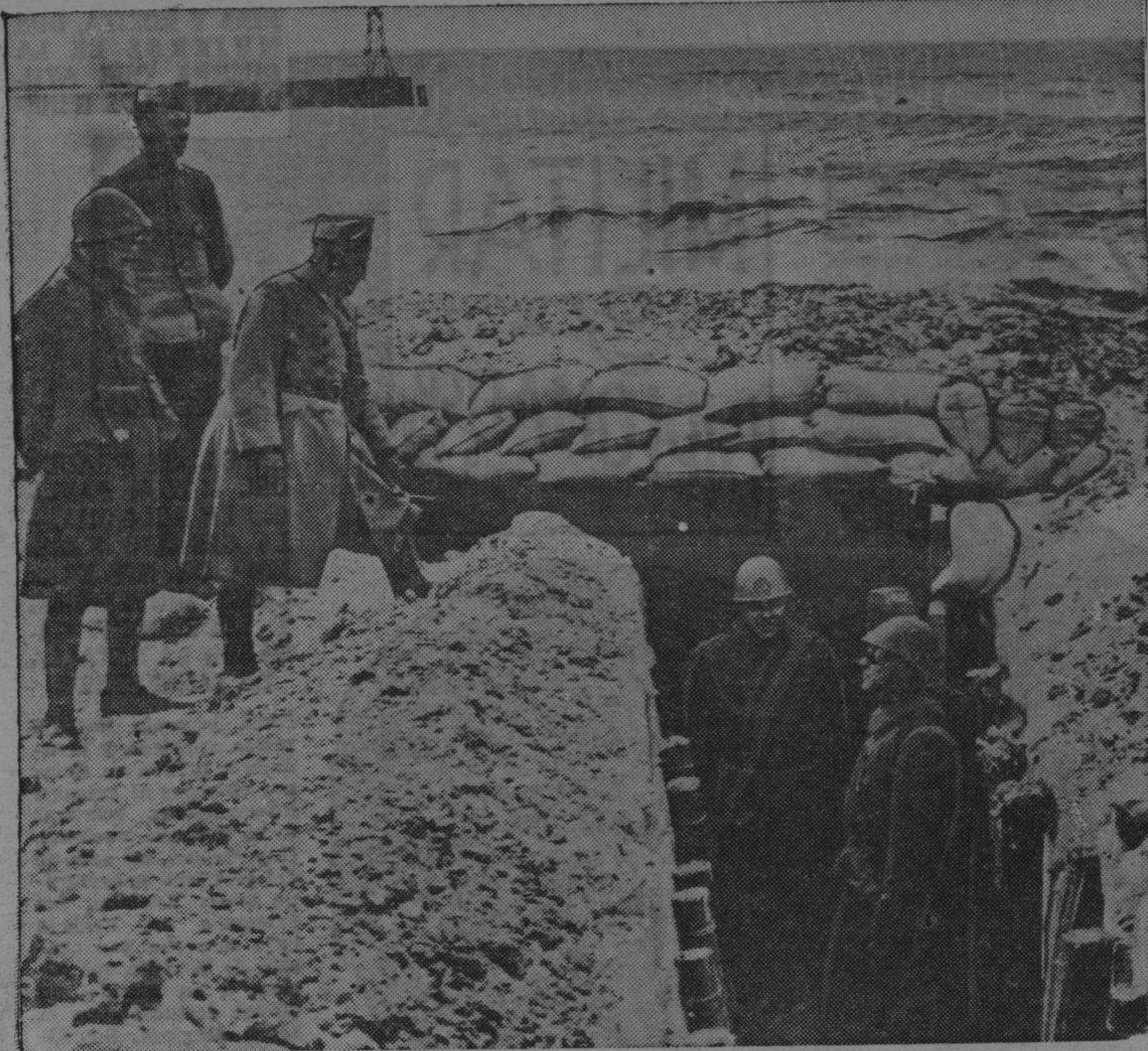
LOS HOLANDESES SE PREPARAN PARA LO PEOR. —A pesar de las repetidas aseveraciones de que su neutralidad será respetada, Holanda ha estado preparando sus defensas con el propósito de cortar el paso a cualquier invasor. Esta es una de las trincheras construidas a la orilla del mar, cerca de Schmeningue. Ciertas áreas estratégicas han sido inundadas y otras lo serían al primer aviso.
