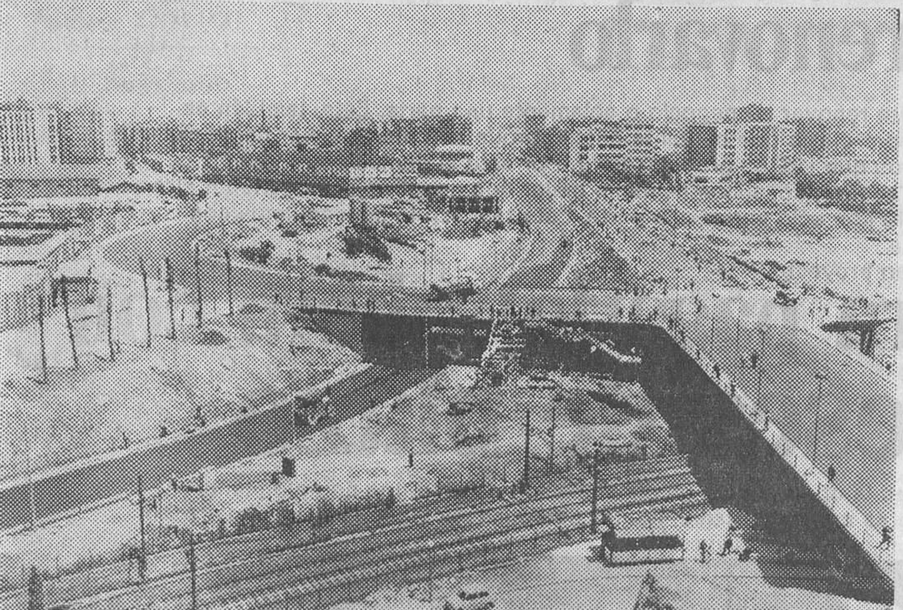
Este es el enlace de la Plaza de las Glorias Catalanas, solución provisional hasta que se construya el nudo a tres niveles estudiado como fórmula definitiva para servir a las autopistas de Mataró y de Granollers. (Foto Soterias)
