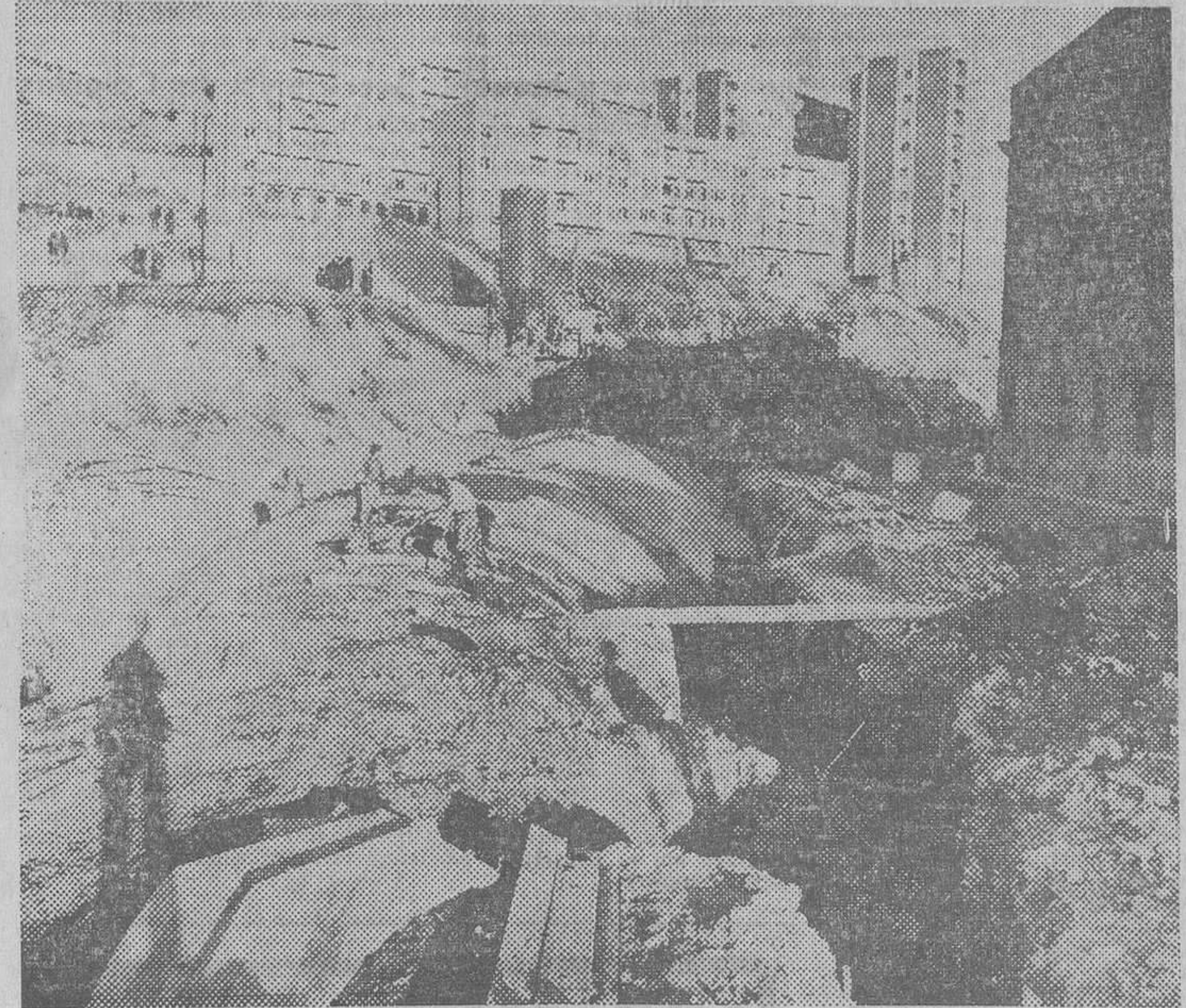
Aspecto de las obras de ampliación de las líneas del Metropolitano Transversal, en el sector Vila-Piscina-Horta. Construcción del túnel en la calle de Cartella. (Foto Cifra)
