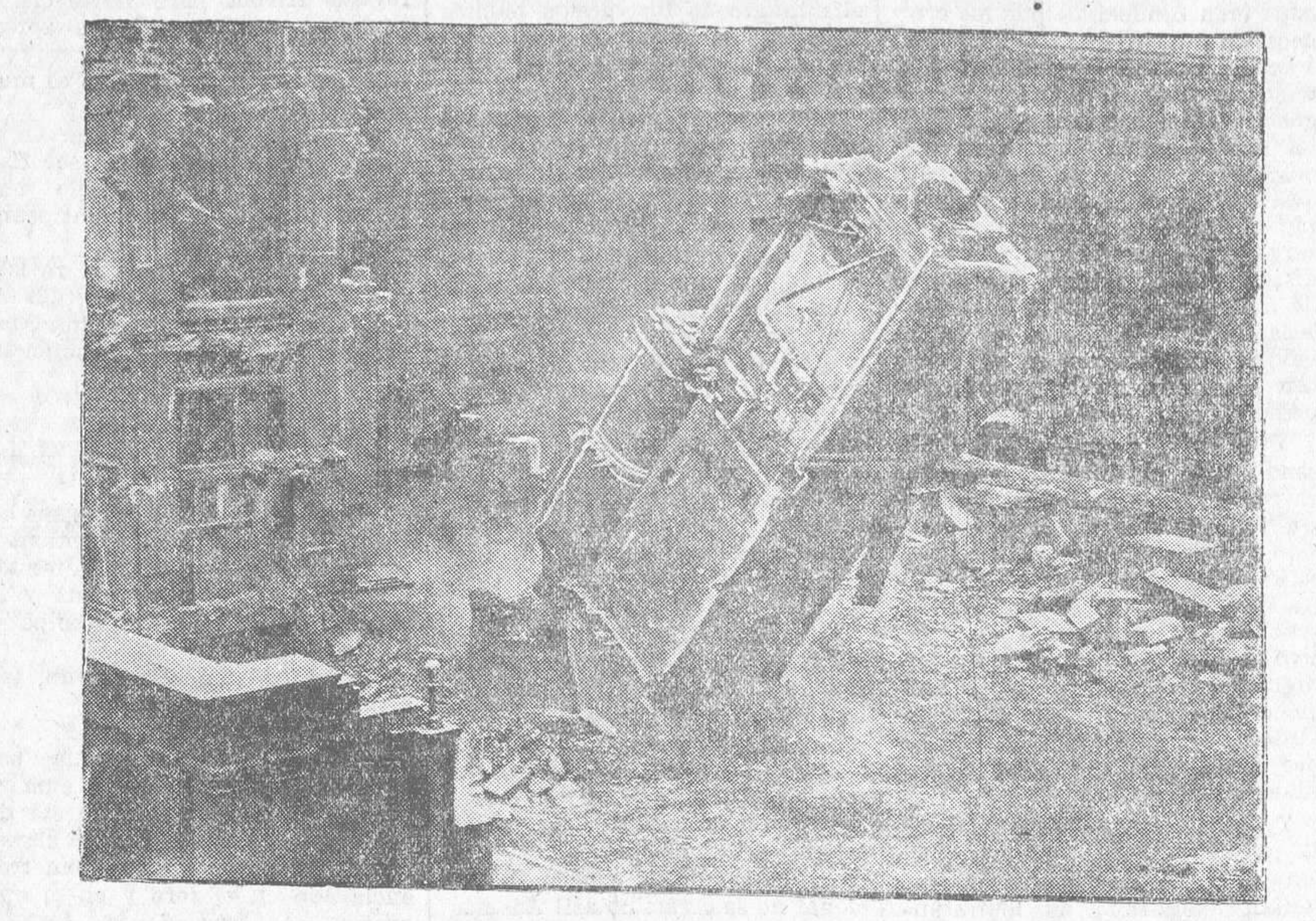
Una columna de granito que pesaba 150 toneladas y que pertenecía al viejo edificio federal, de Boston, ha tenido que ser derribada mediante el impulso de dos enormes grúas de 85 caballos de fuerza cada una
