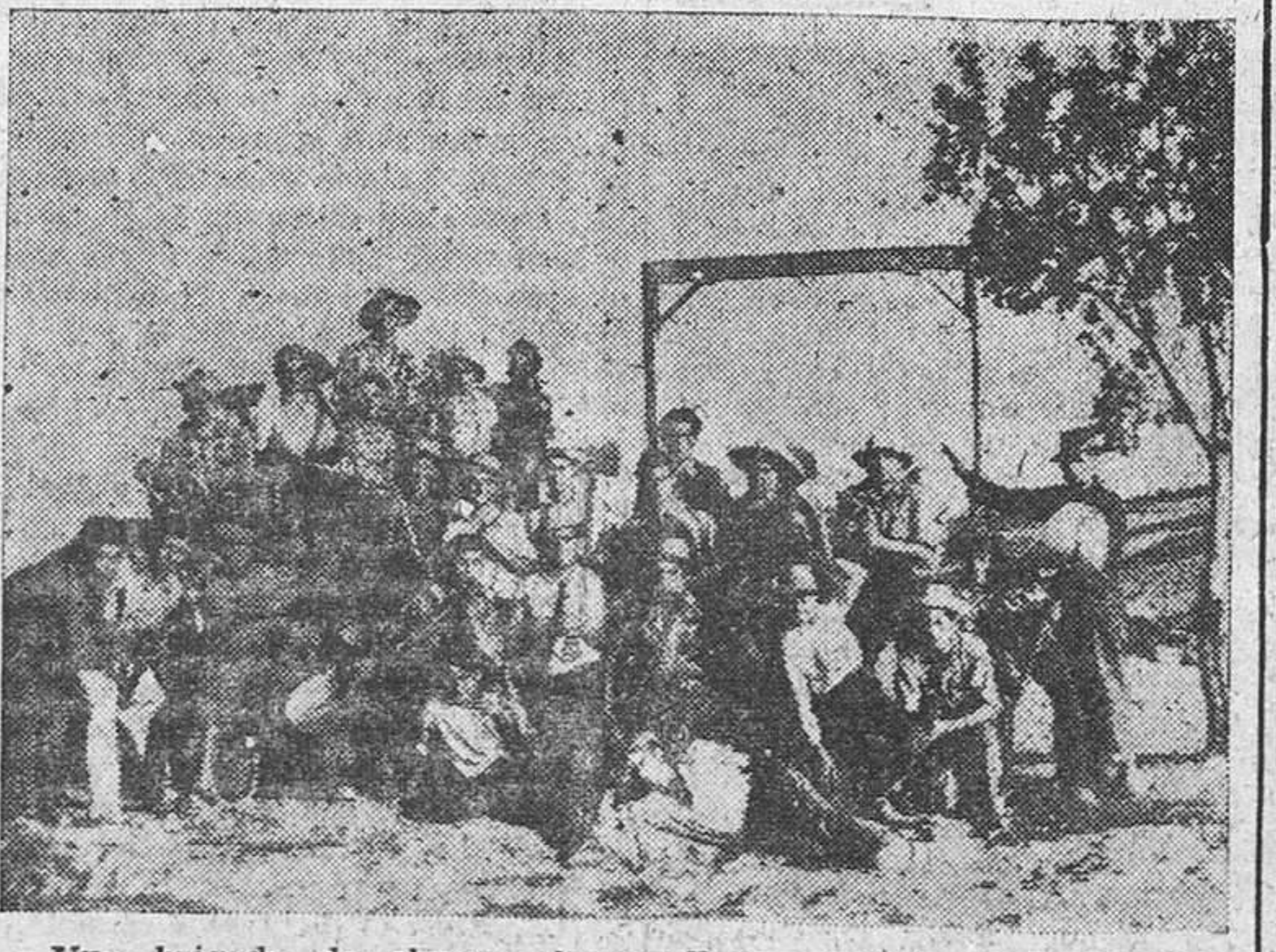
Una brigada de obreros fermosellanos que trabajan en las obras de reparación y riego de asfalto de la carretera de Zamora, en el tramo Puente de Pelazas-Fermoselle...
