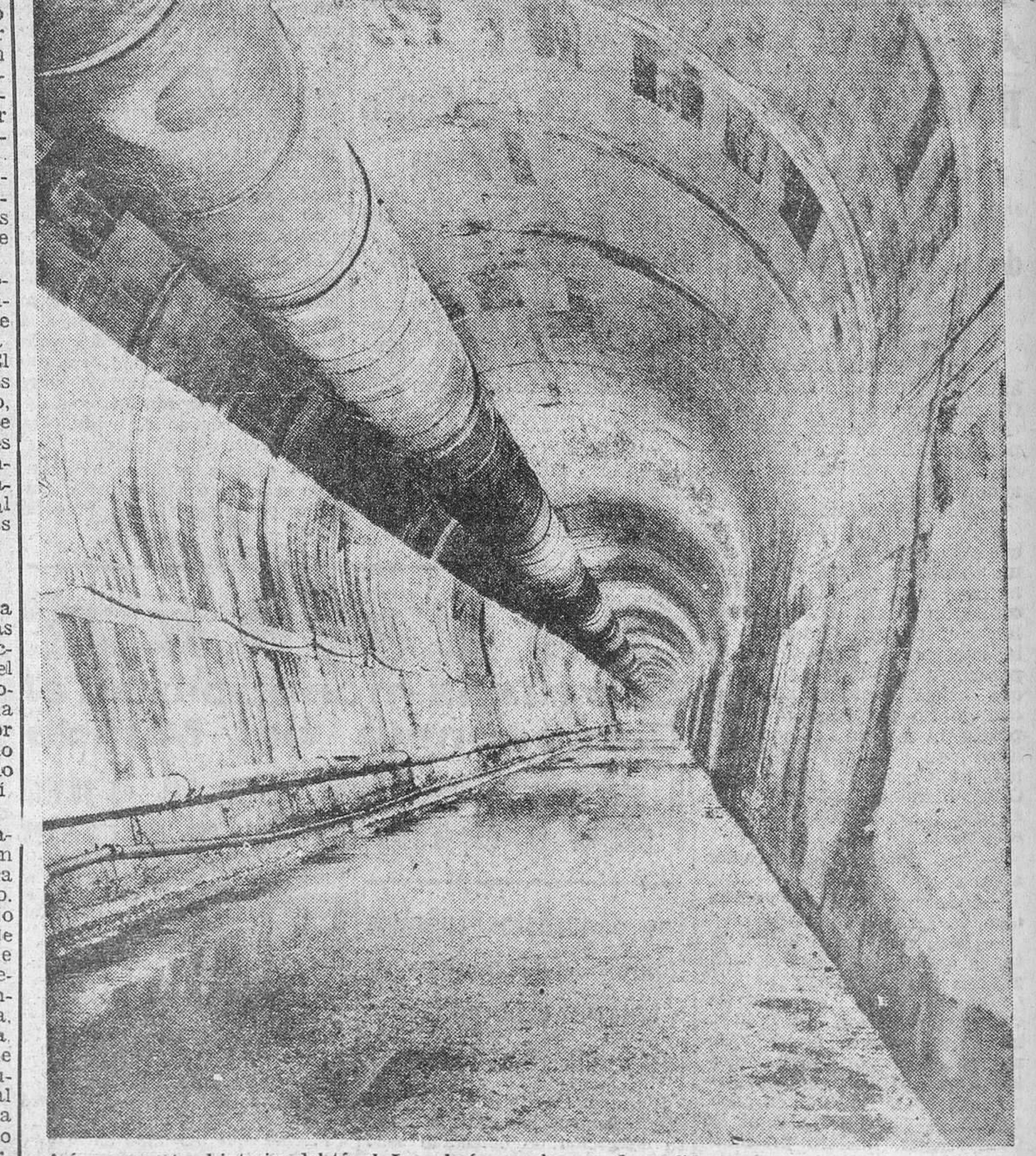
Así se presenta el interior del túnel. La galería, con las paredes pulidas, muestra los focos de iluminación adosados. A cierta altura del suelo, a la izquierda, se ve el tubo de inyección de aire, y en lo alto, la conducción de gases nocivos que se extraen del túnel.
