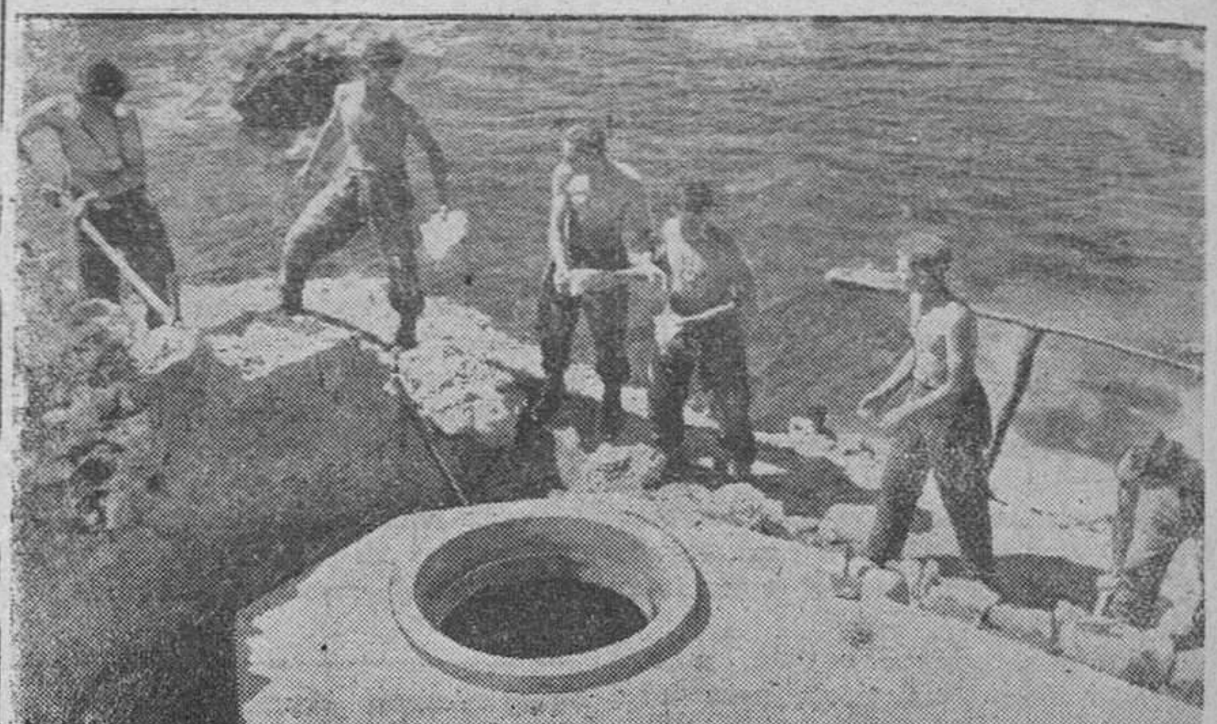
Miembros del servicio alemán del Trabajo construyendo fortines de cemento armado en las costas europeas del Mare Nostrum
