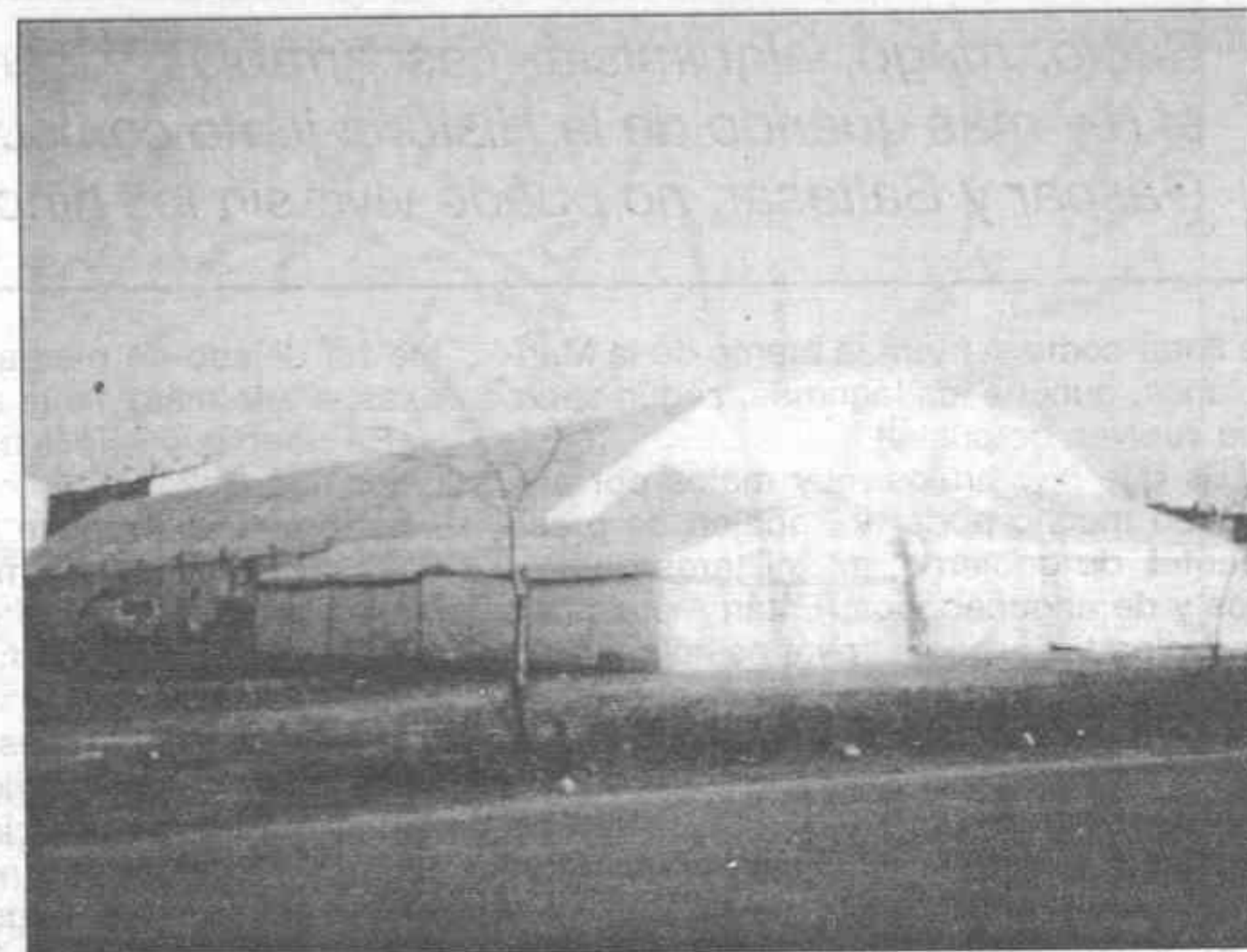
El vendaval del día de fin de año abrió algún hueco en el techo y paredes de la cubierta ignífuga.
