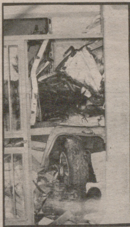
La cabina del camión, después de atravesar la puerta del mesón, el mostrador y una pared, llegó hasta el patio que da paso a las viviendas del edificio.
