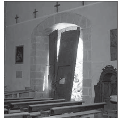
Una puerta lateral quedó destrozada
