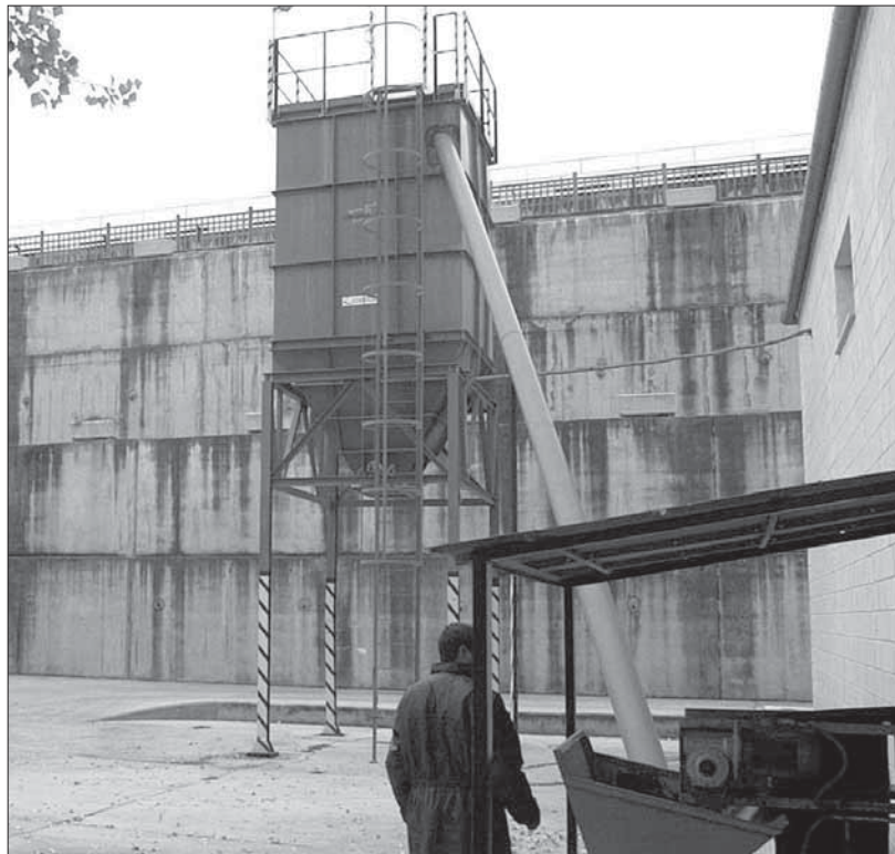
Imagen del silo en el que se depositan los lodos de la depuradora antes de su traslado
