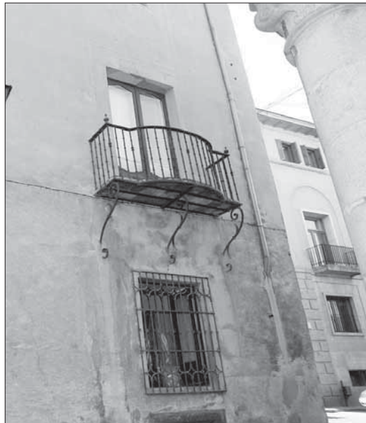
Manchas de humedad en la fachada del Palacio
