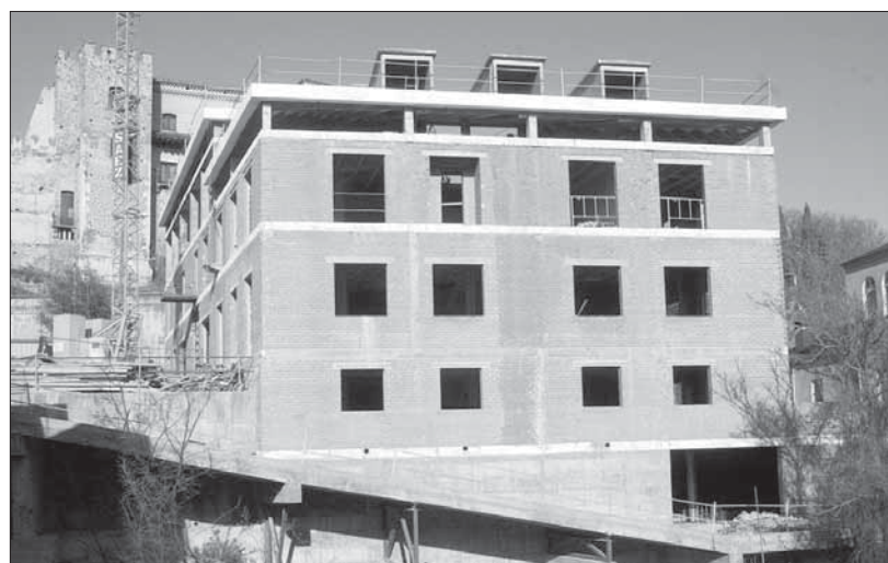
El edificio, ubicado en una zona especialmente sensible, ha creado alarma en la ciudad
