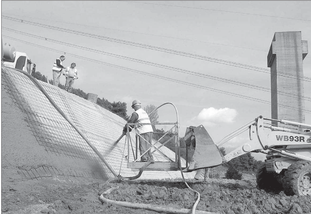
Los trabajos en la Sierra de Guadarrama se centraron en la limpieza de la zona para empezar a perforar la ladera
