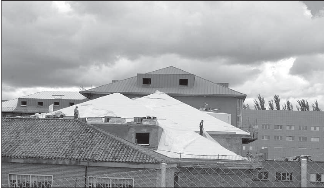
Un chubasco moderado de verano desbordó las previsiones de los responsables de las obras de reparación de la cubierta del hospital
