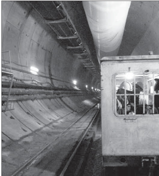
Dentro de unos meses concluirá la excavación de los túneles del TAV
