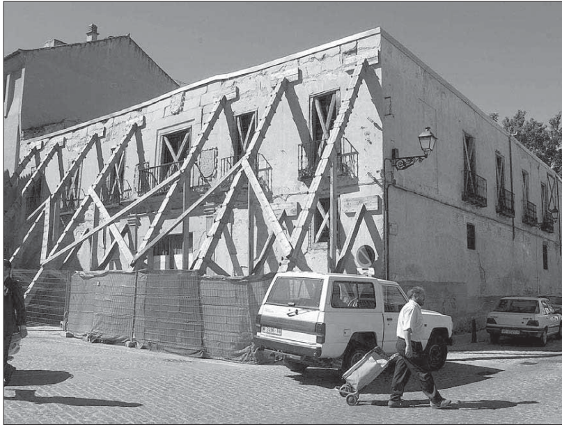
El Palacio de Enrique IV permanece apuntalado y se está deteriorando rápidamente
