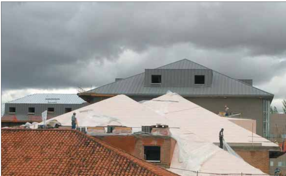
Los trabajadores instalaban ayer plásticos en la cubierta, bajo unas nubes que seguían amenazando descargas de lluvia
