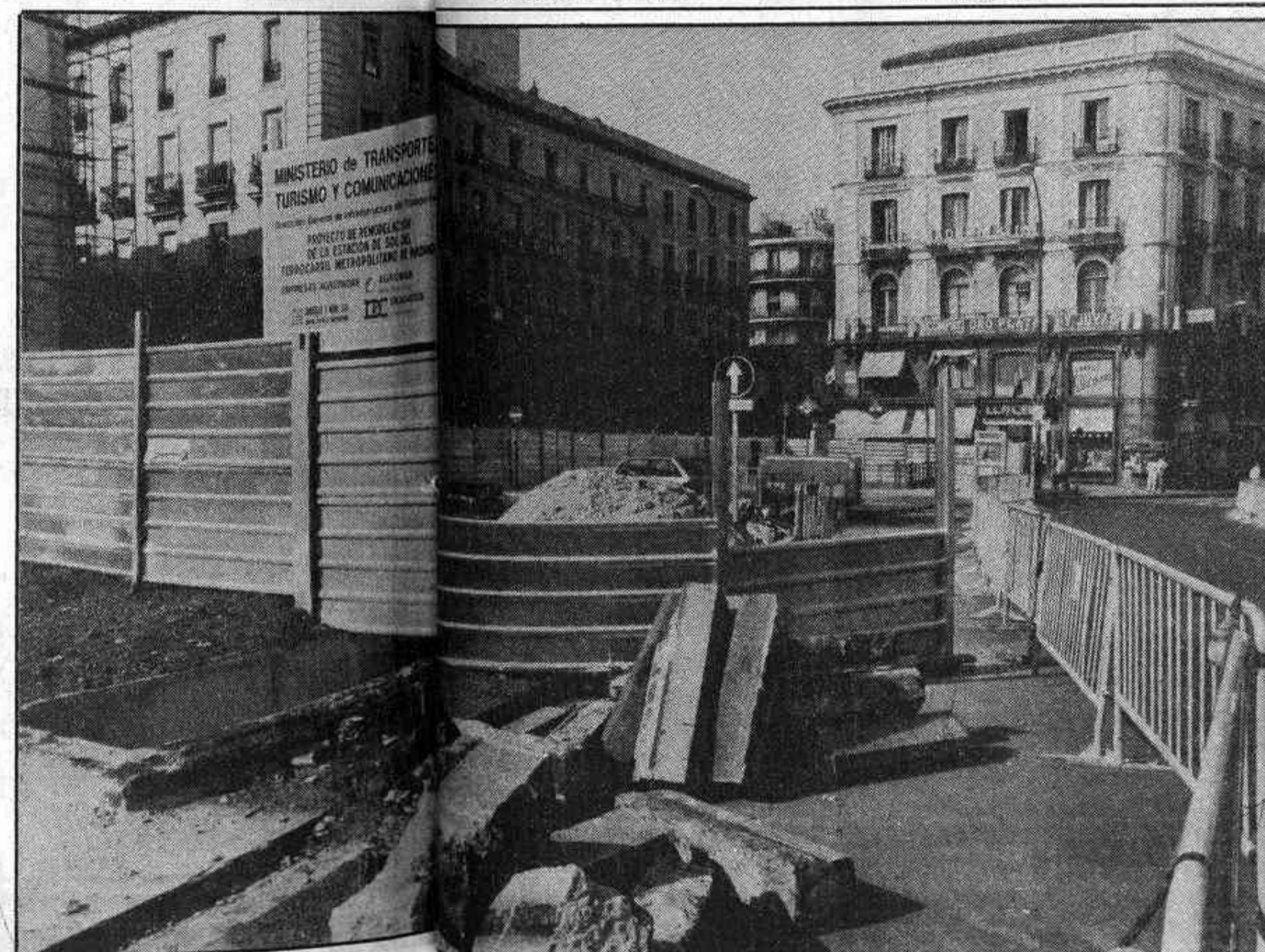
Los trabajos de superficie de la obra deberán estar terminados el 30 de marzo de 1986, para que el Ayuntamiento pueda efectuar la remodelación de la plaza de la Puerta del Sol.
