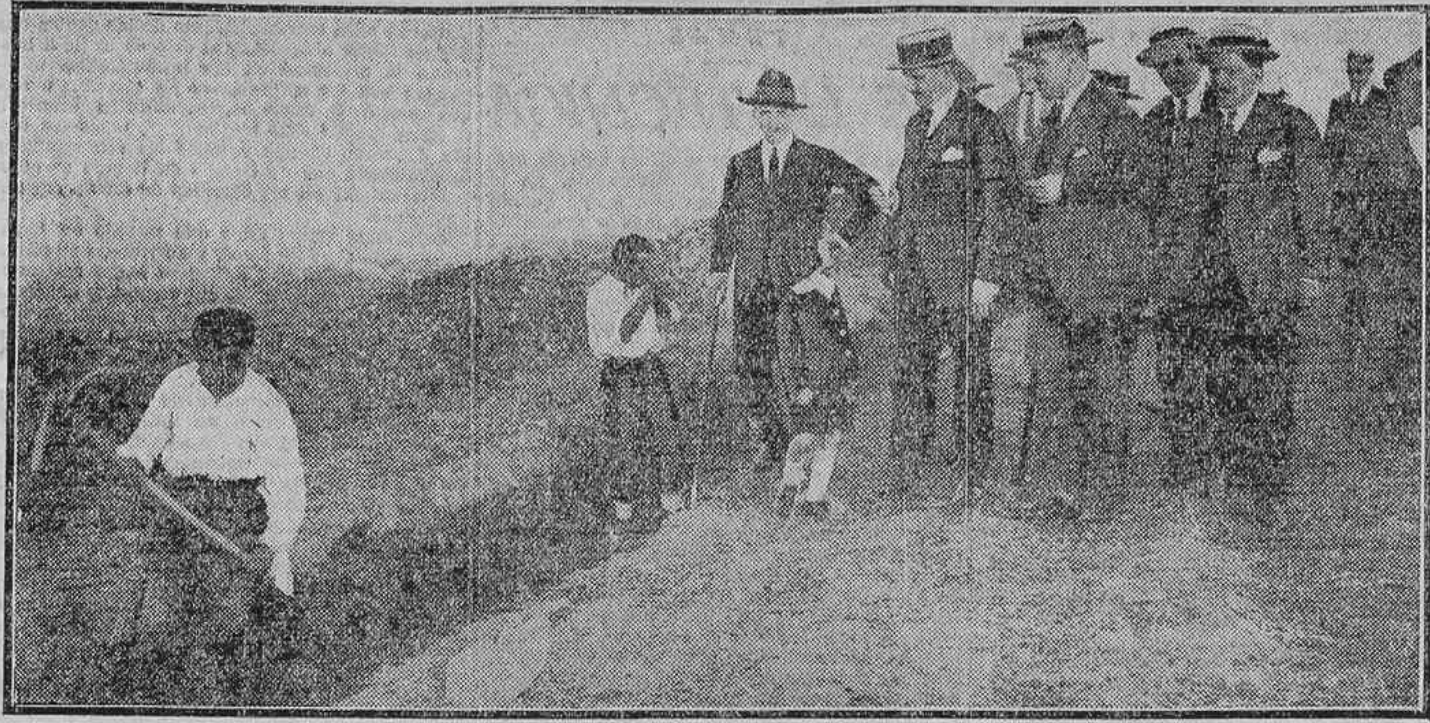
EL CONDE DE VALLELLANO VISITANDO LAS OBRAS DE LA CIUDAD JARDIN DE SU NOMBRE, QUE DIRIGE EN LA CARRETERA DE EXTREMADURA, COMO JEFE TECNICO, EL SR. TARRAGA (Fot. Alfonso.)
