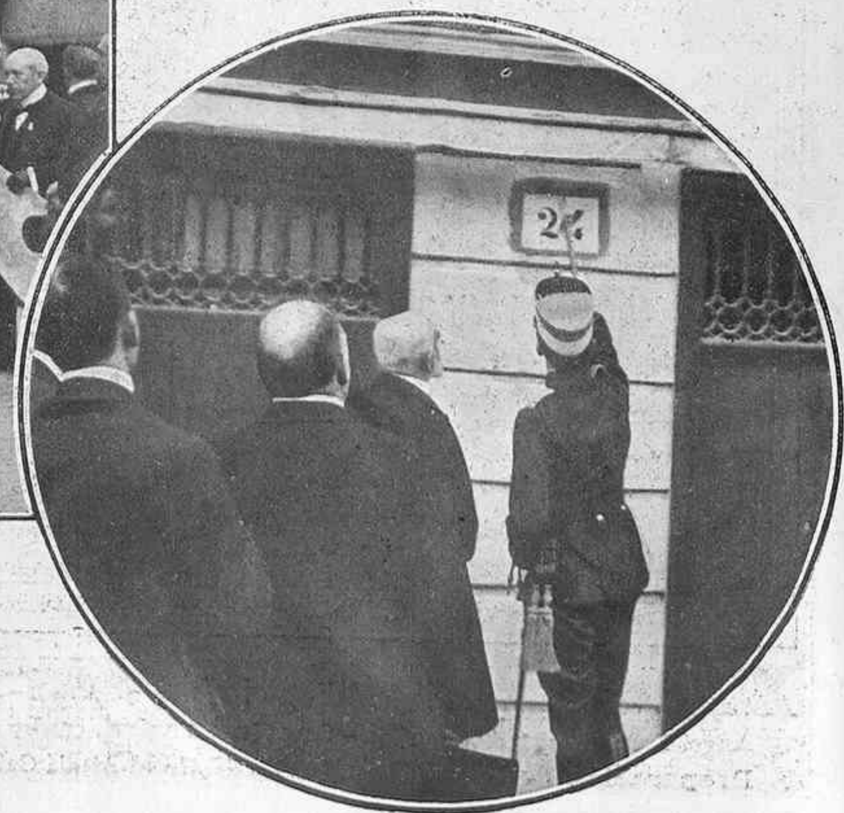
S. M. el rey iniciando los derribos para las obras del Mercado Central (De fotografías de Barberá Masip.)
