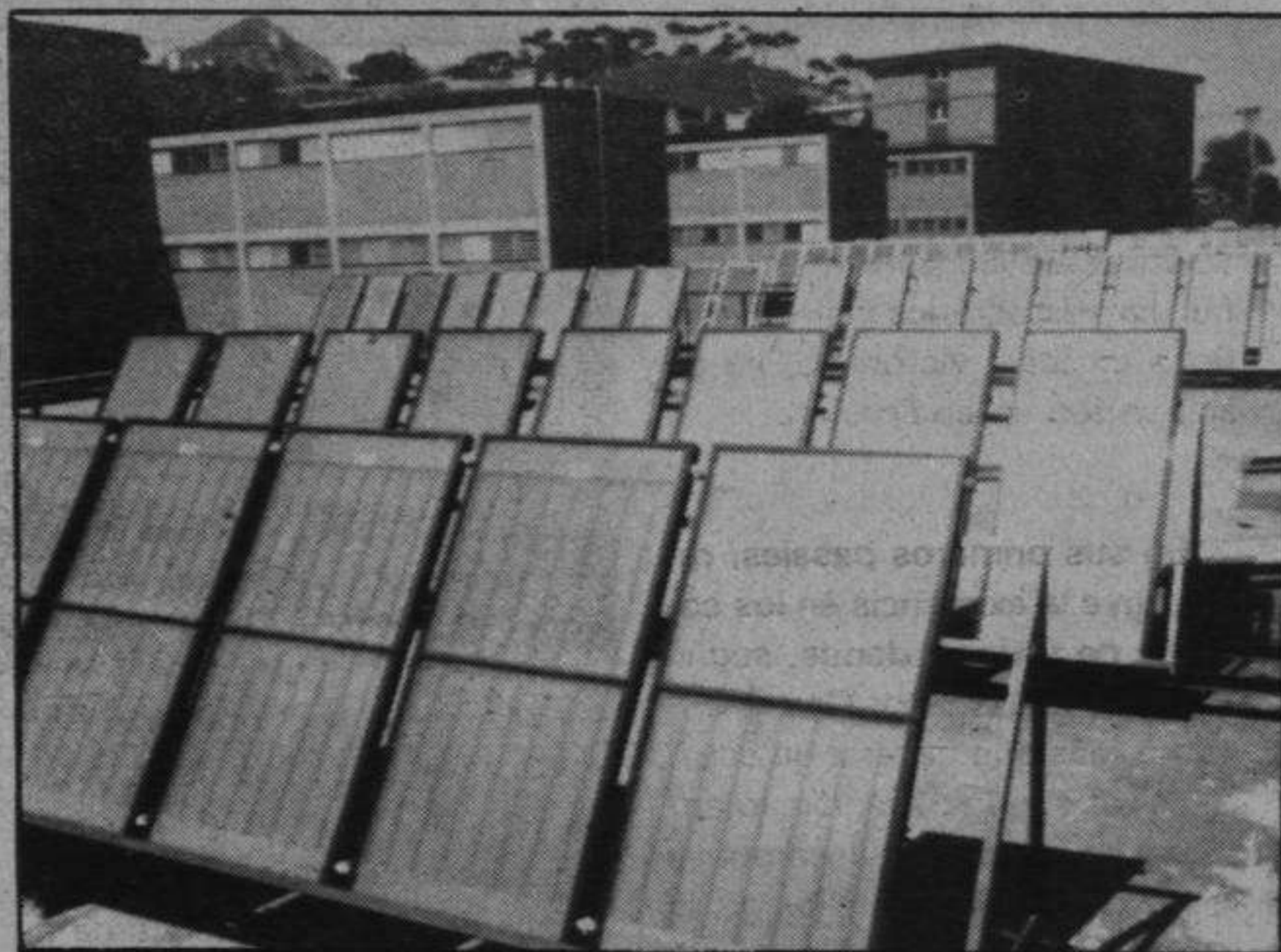
Paneles solares para proporcionar energía a las viviendas
