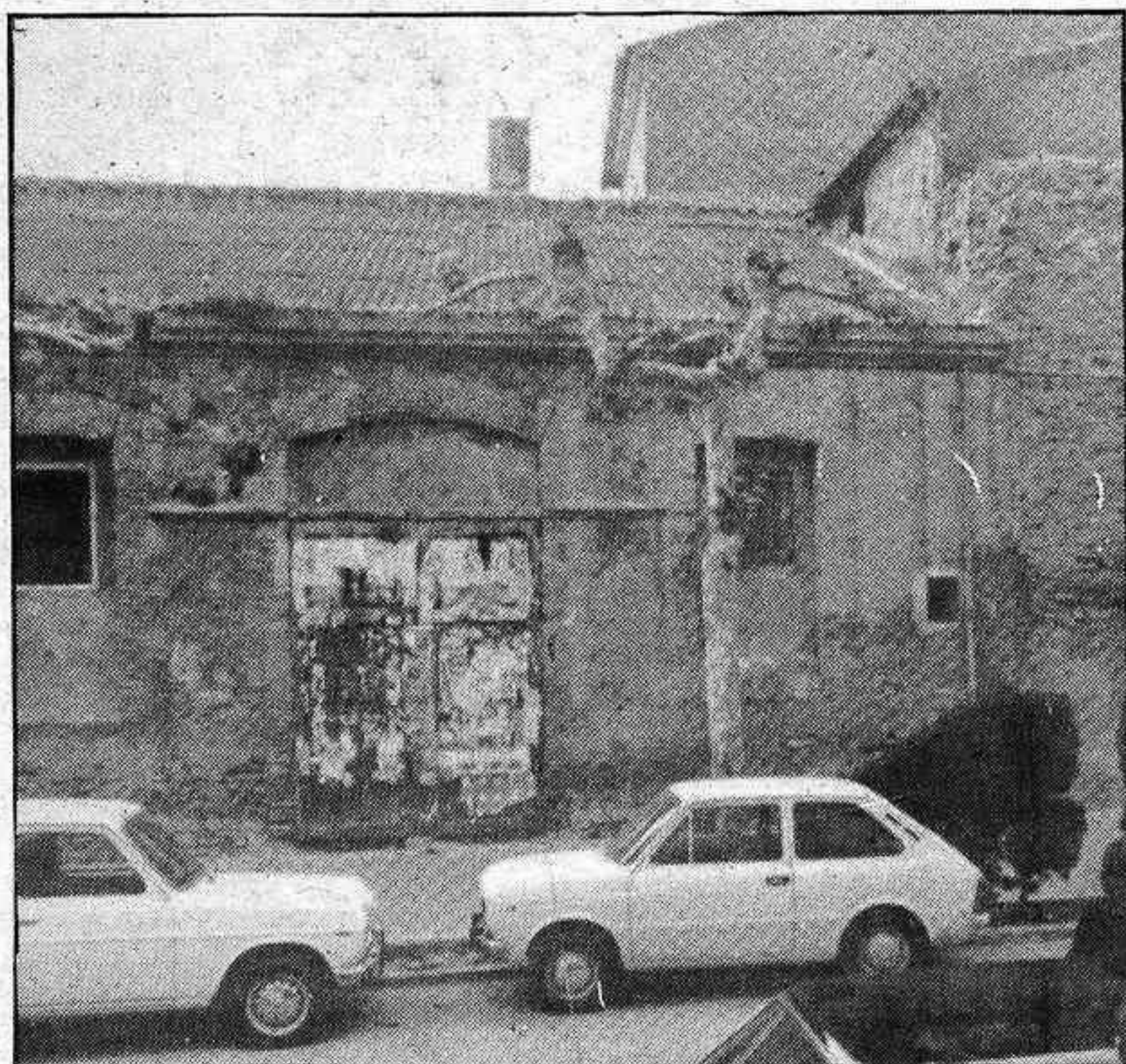
El Ayuntamiento frenará el deterioro del edificio
