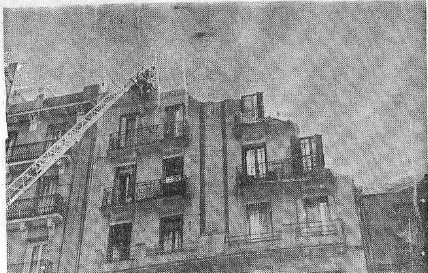
MADRID. — Los bomberos derribando la parte superior de la casa número 74 de la calle García Morato, que desde la madrugada pasada presentaba grandes muestras de derrumbamiento. Los ocupantes de las viviendas de dicho edificio fueron desalojados al comprobarse dicha amenaza. — (Telefoto CIFRA GRAFICA)
