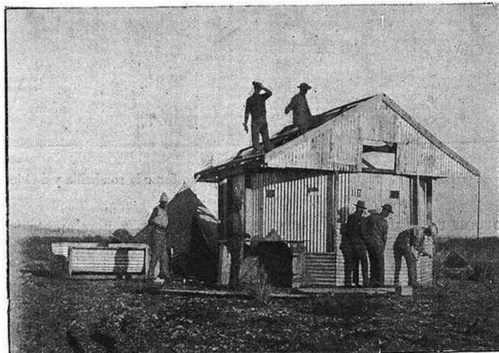
CONSTRUCCIÓN DE UN BLOCAO Aspecto del blocao en el segundo día de su construcción
