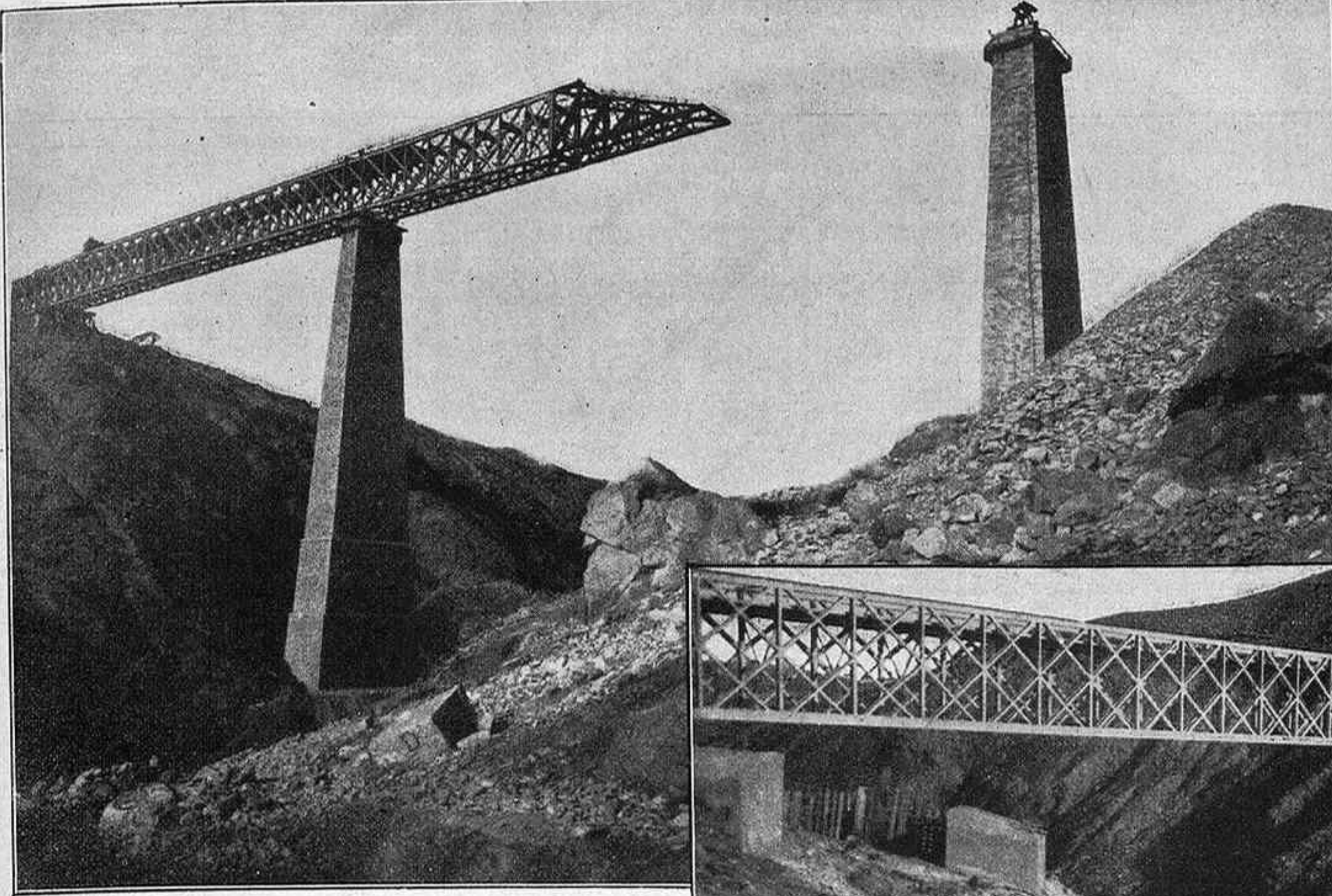
FERROCARRIL DE LINARES Á ALMERÍA. — EL VIADUCTO DEL SALADO. — OPERACIÓN DE CORRER UNO DE LOS TRAMOS DEL PUENTE SOBRE LAS PILASTRAS (de fotografía de López, de Baeza).
