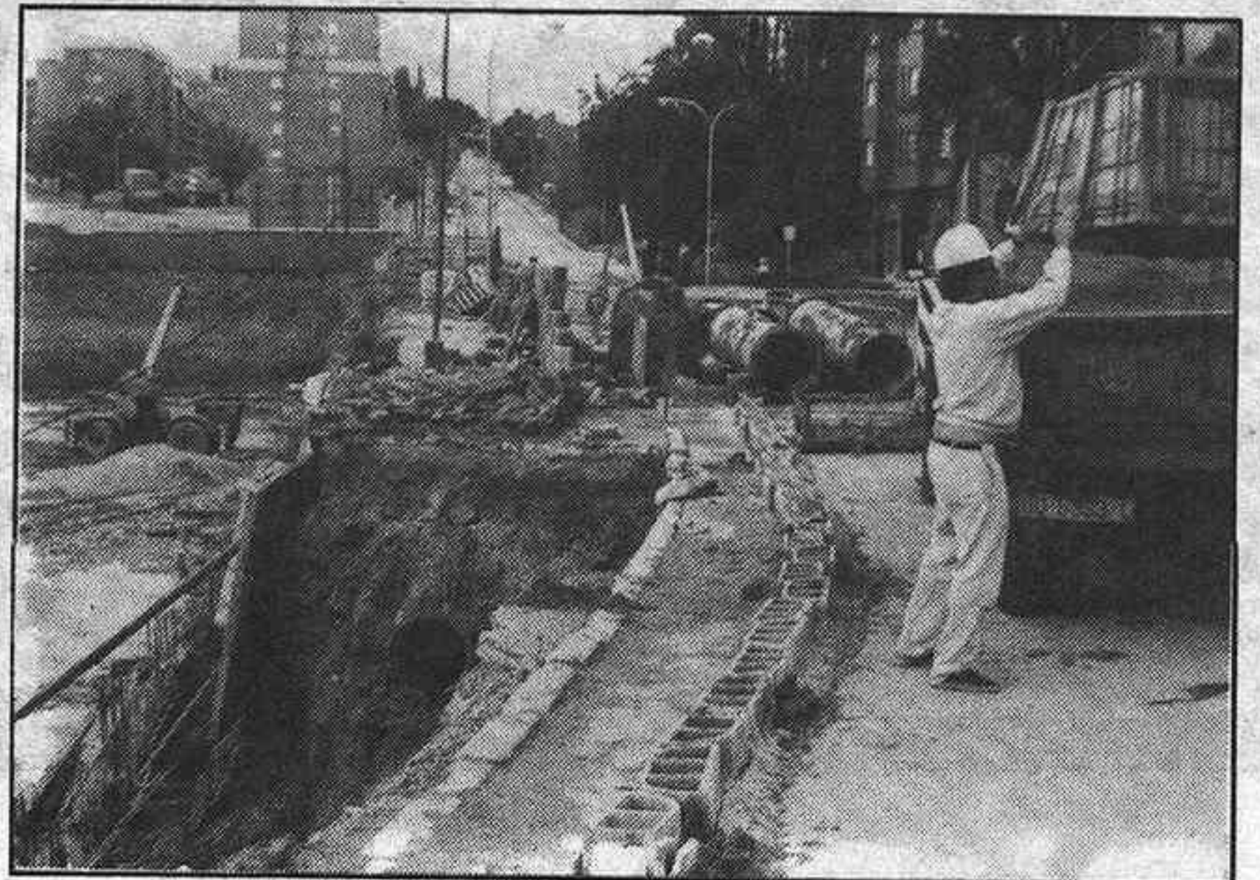
La conducción quedó seccionada en un tramo superior a los 40 mts
