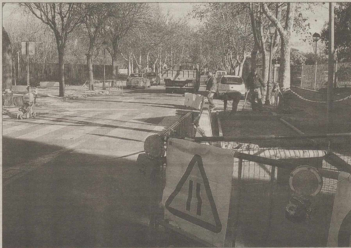
Imagen de las obras que se llevan a cabo para la eliminación de bandas reductoras en la calle de San Juan. / LUIS BONETE
