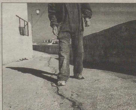
La grieta causante del desalojo. / R.SERRALLÉ
