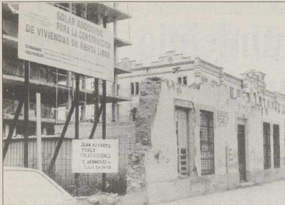
La primera promoción de viviendas se ha hecho en el Paseo de la Cuba.
