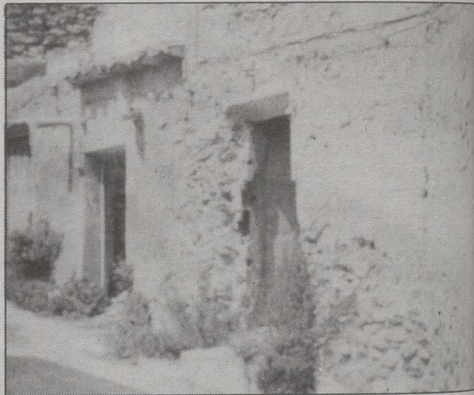
El Estado que presenta es lamentable.
