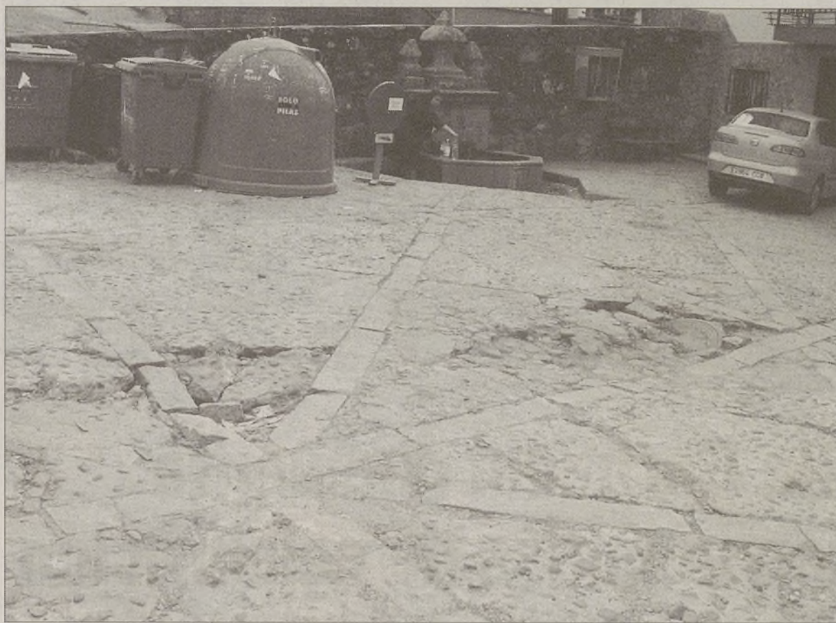
Estado de una zona del firme de la plaza de La Nava, deteriorado por el continuo pasos de vehículos pesados. / LACABA
