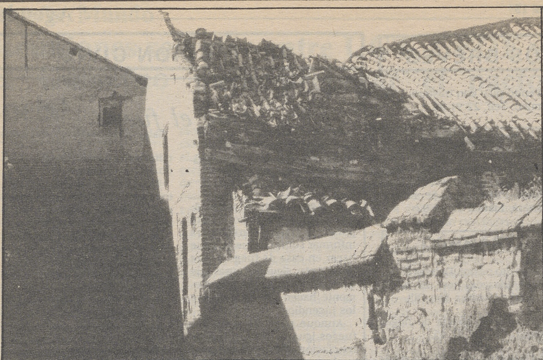
El tejado de la casa, caído, visto desde su parte posterior
