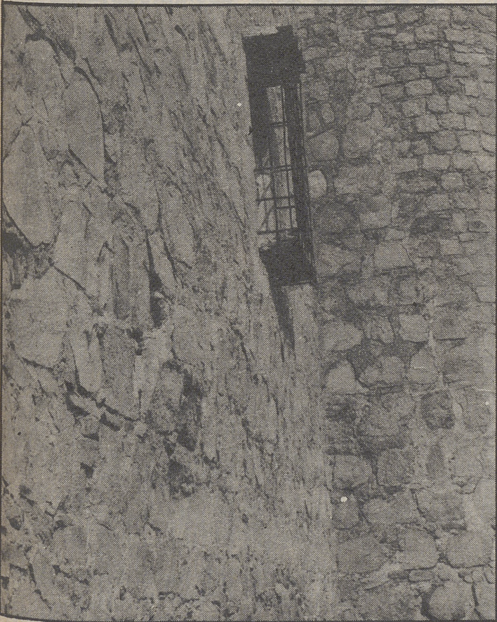
En el lienzo del Obispado, frente al Paseo del Rastro, se está produciendo un abombamiento paulatino VICTOR
