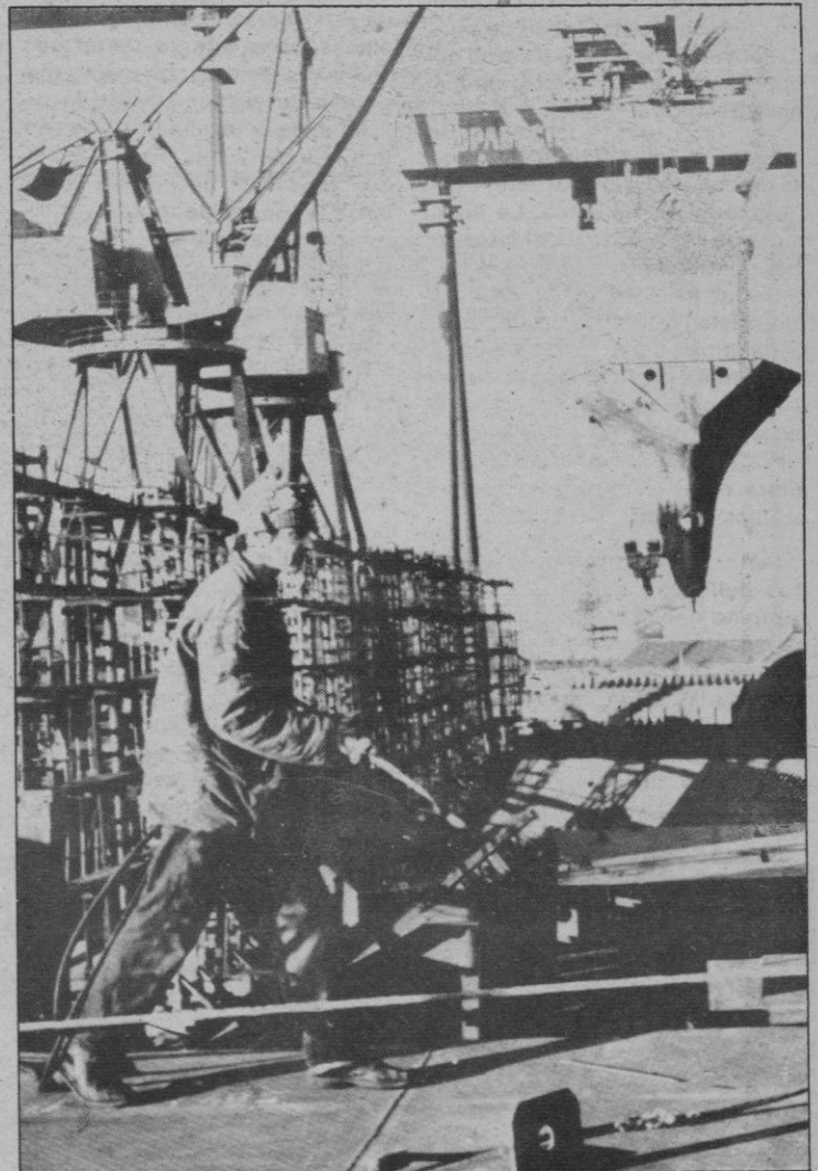
Trabajo, riesgo... ¿seguridad?
