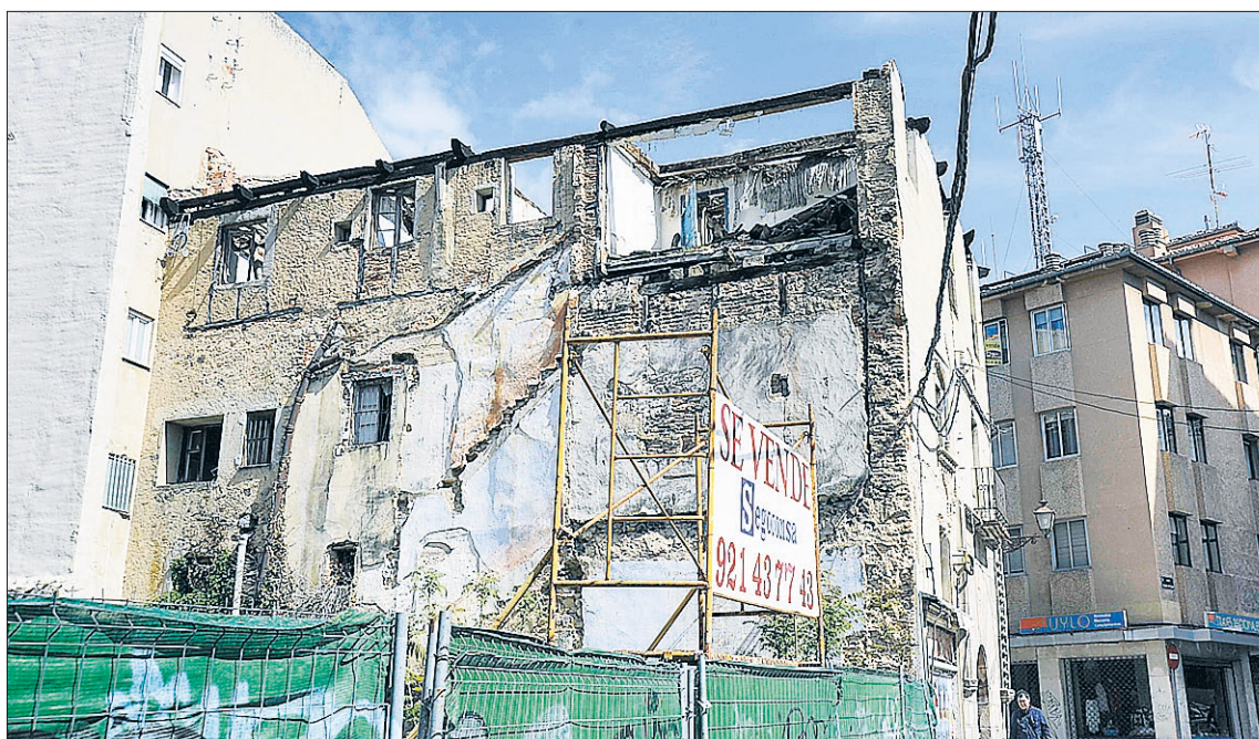
Ruina de la Casa de los Buitrago y, en primer plano, solar donde se podrá construir un edificio residencial. / KAMARERO
