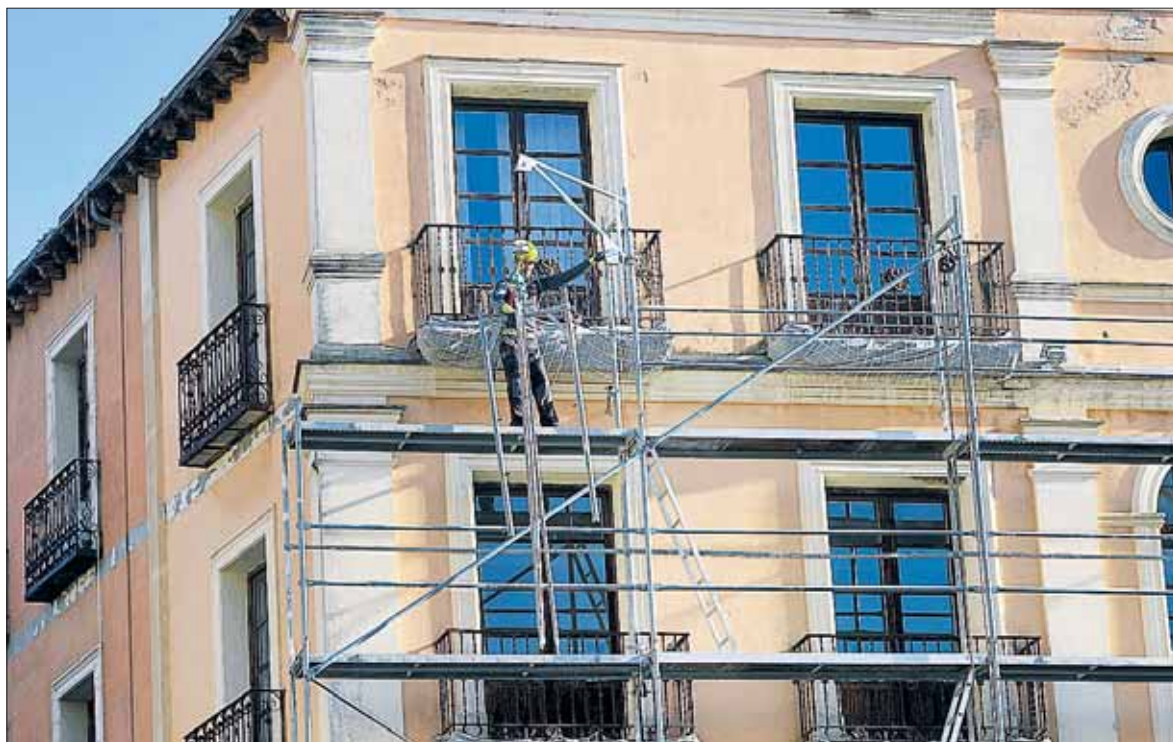
Los trabajos en el exterior, para los que se colocaron andamios, fueron ejecutados el pasado invierno. / KAMARERO
