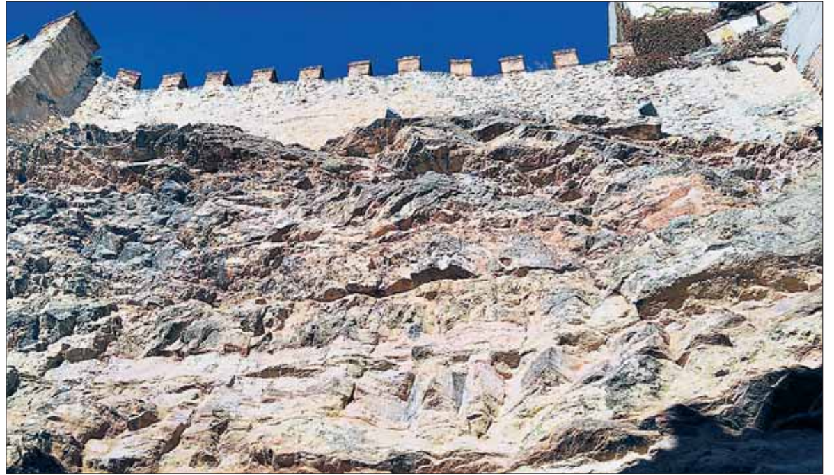
Estado de la roca en la que se apoya la Muralla de Segovia junto a la calle de San Juan. / E. A.
