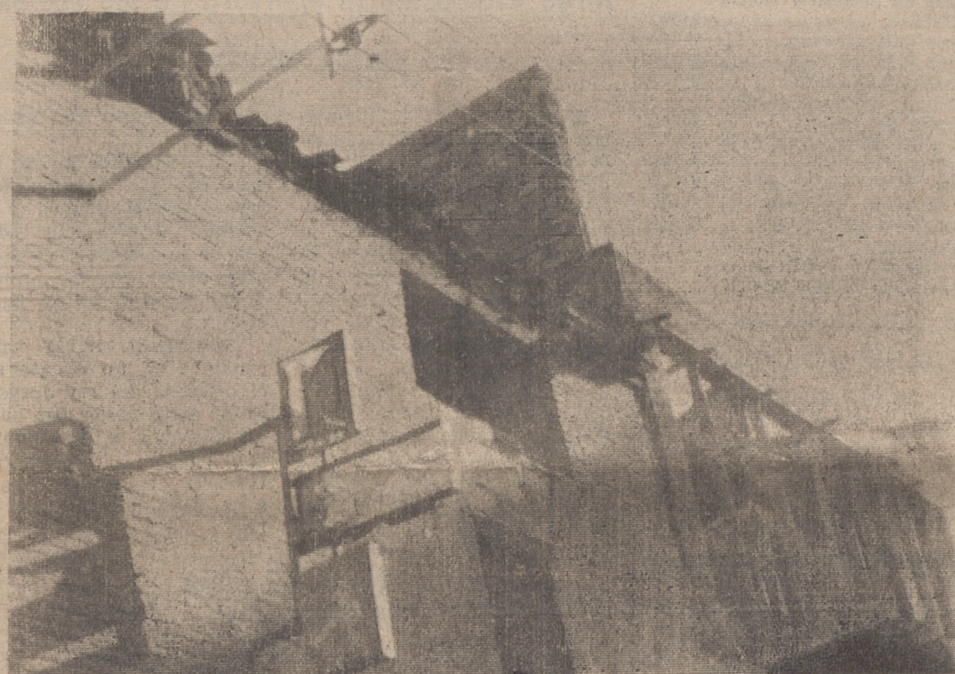
Cornisa desplomada. — (Foto Sánchez)
