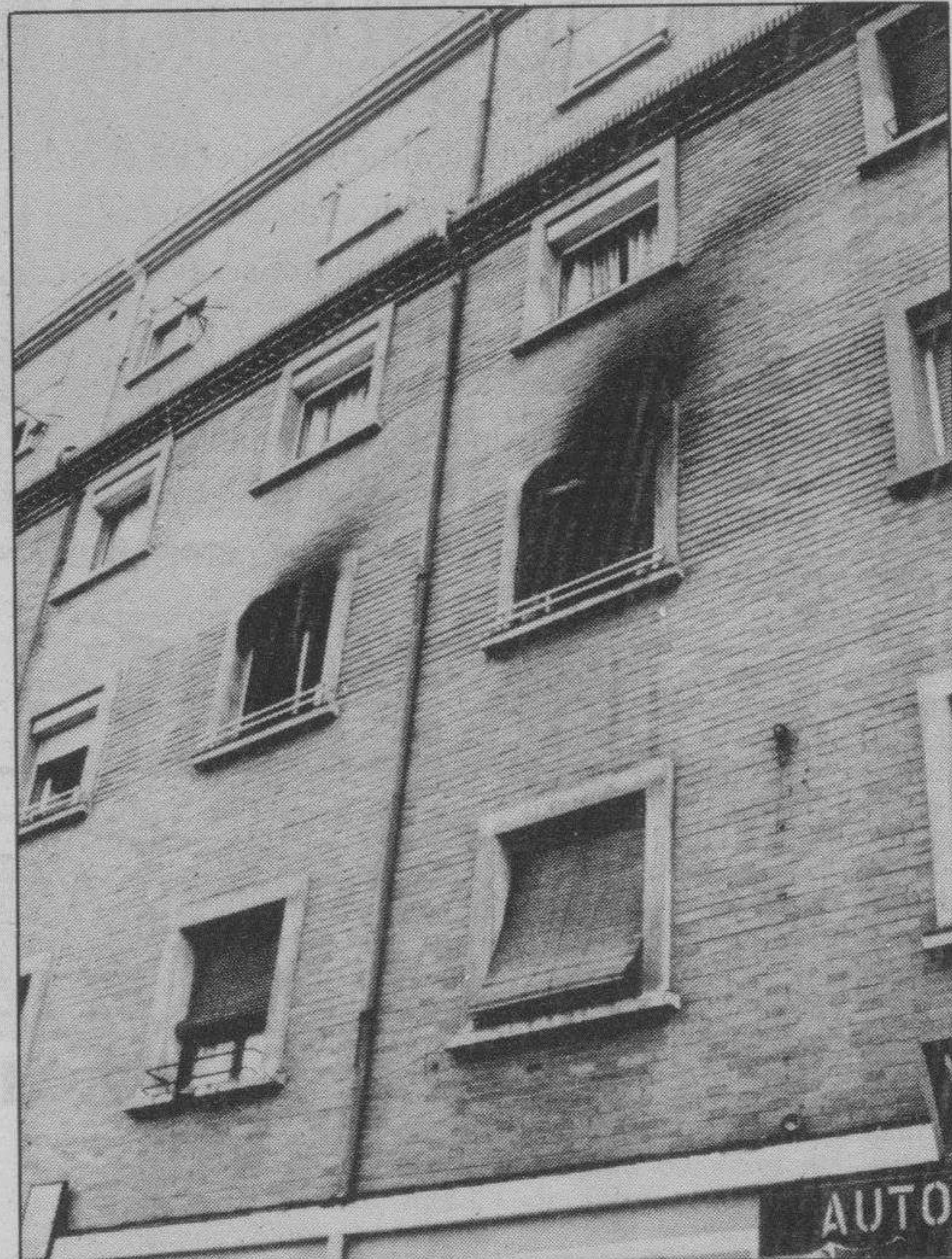
La vivienda quedó completamente destruida. (Foto: Truchuelo).
