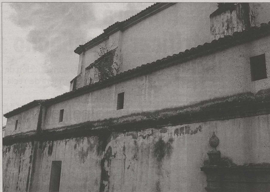
La Iglesia de la Asunción se encuentra en un estado lamentable. / CEDIDA
