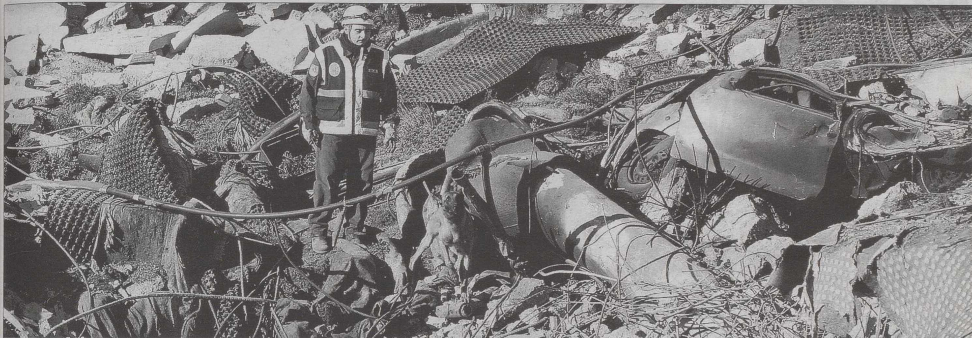
Las ininterrumpidas labores de desescombro que se llevan a cabo en el estacionamiento de la T-4 posibilitaron que los equipos de rescate, ayudados por perros, localizaran el cuerpo de la primera víctima mortal. / EFE
