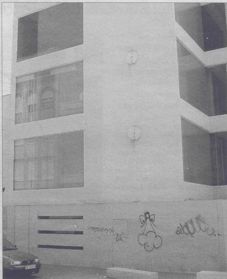
El edificio de los Juzgados no se ha librado de las pintadas callejeras./A. ROMERO
