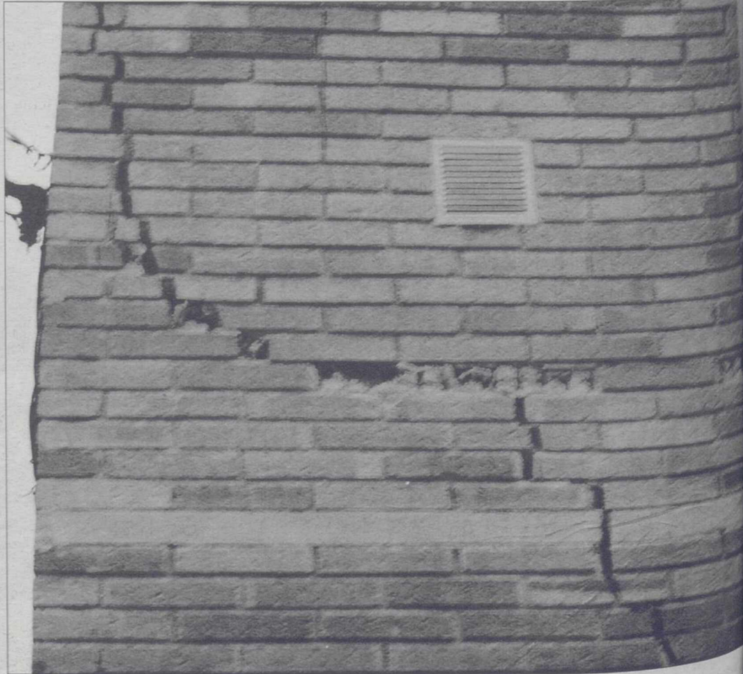
Grieta existente en el Colegio Público «El Rosario». / A. ROMERO
